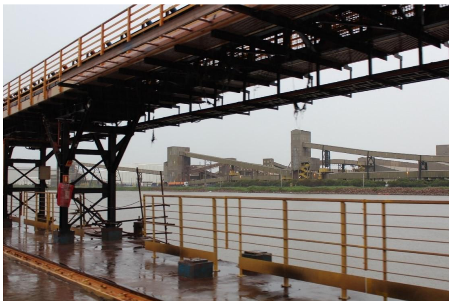
Figura 39: Infraestrutura de suporte ao transportador contínuo: Yara, Superporto
