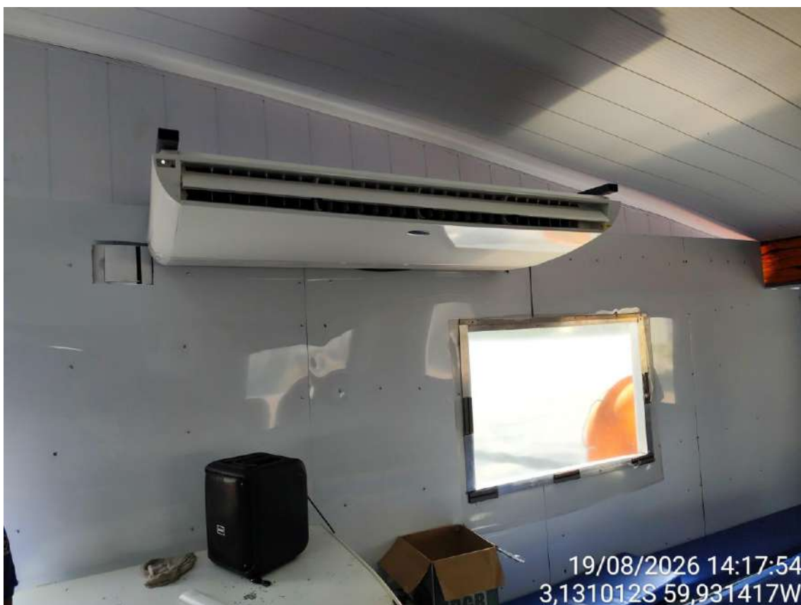
Foto 75 – Área da embarcação contendo ar-condicionado para os passageiros.
