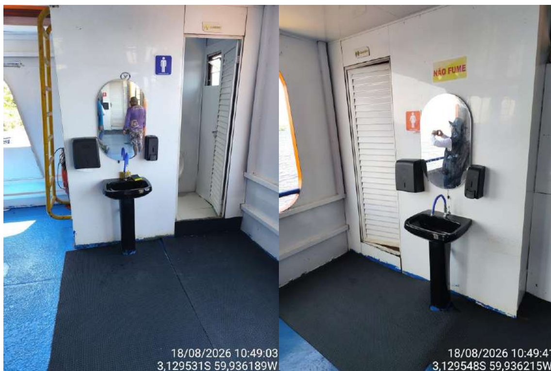
Foto 62 – Demais sanitários e lavatórios na embarcação.
