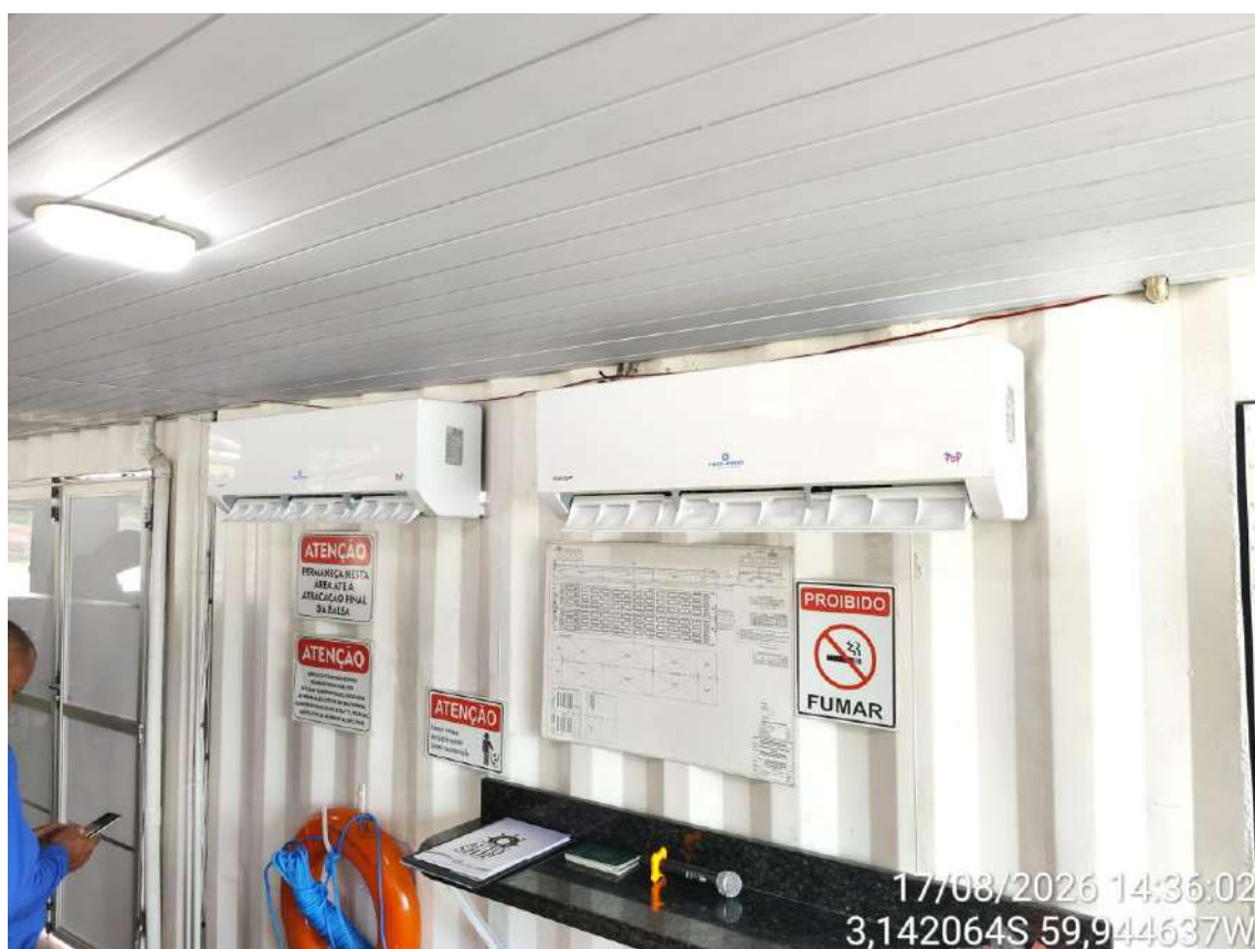
Foto 31 – Área da embarcação contendo ar-condicionado para os passageiros.
