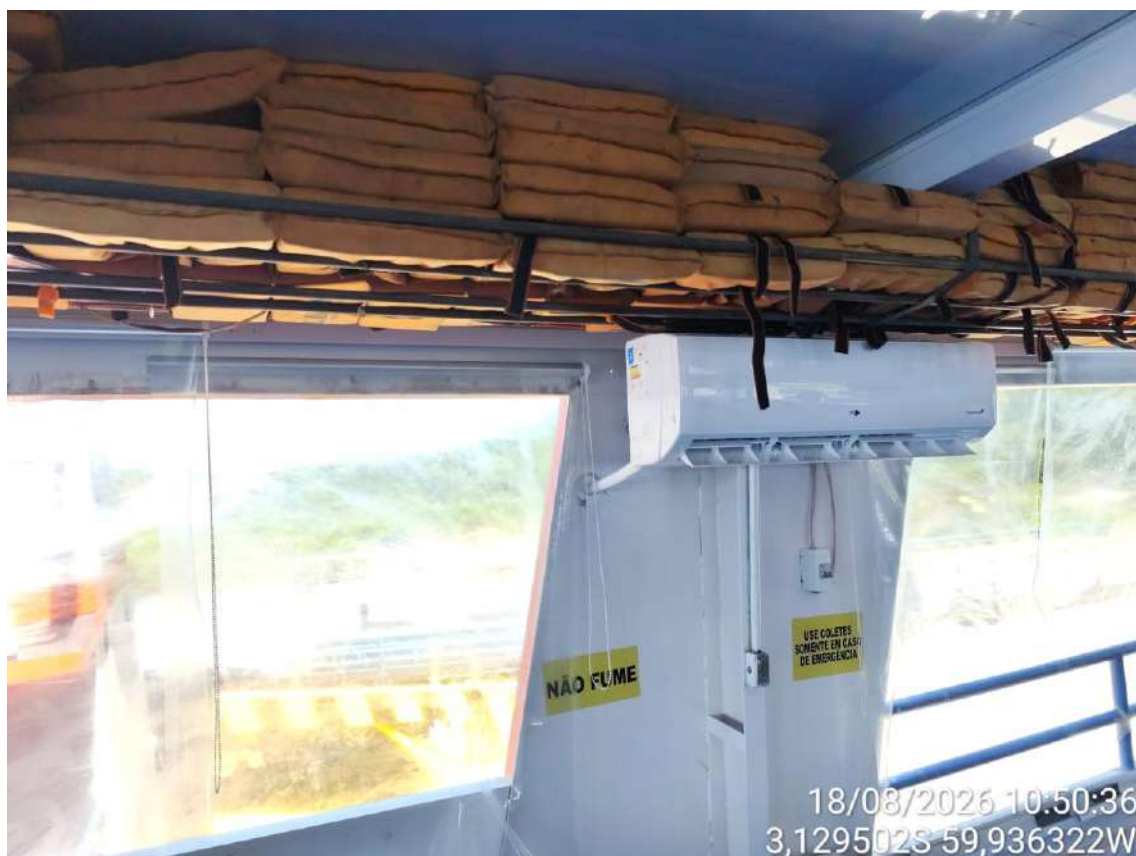
Foto 64 – Área da embarcação contendo ar-condicionado para os passageiros.
