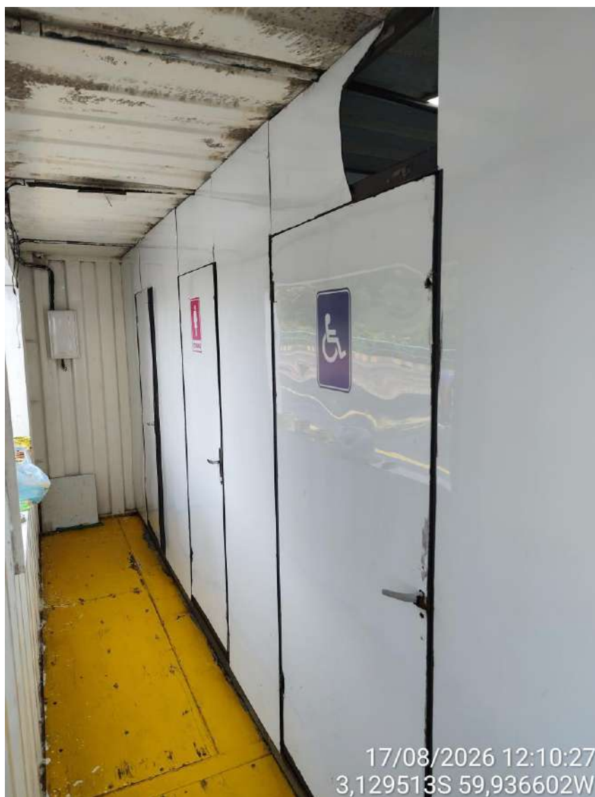
Foto 18 – Demais sanitários e lavatórios na embarcação.
