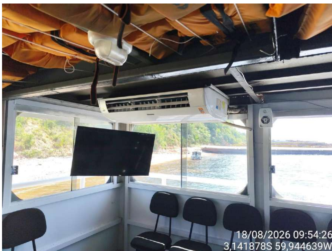
Foto 42 – Área da embarcação contendo ar-condicionado para os passageiros.
