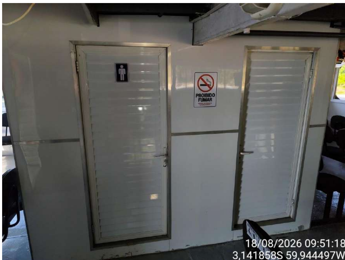
Foto 40 – Demais sanitários e lavatórios na embarcação.
