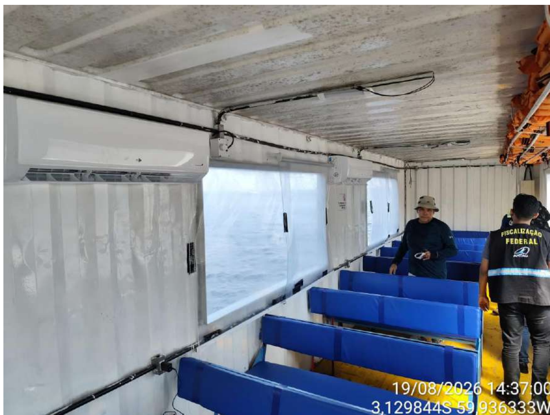
Foto 20 – Área da embarcação contendo ar-condicionado para os passageiros.
