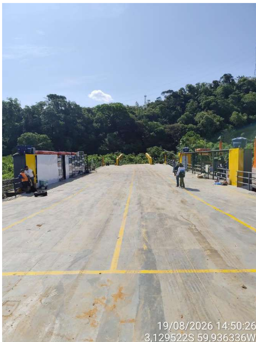
Foto 78 – Vista a partir da popa da embarcação contendo dispositivos para evitar a queda de passageiros (guarda corpo ou barras de apoio) na embarcação.
