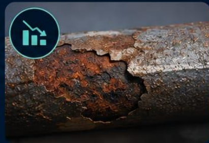
DEGRADAÇÃO E FALHA DE EQUIPAMENTOS
