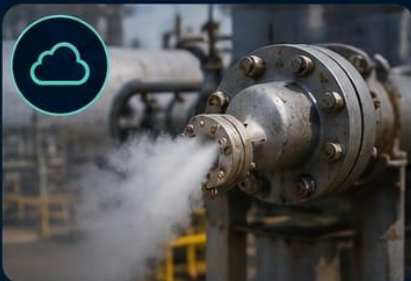
VAZAMENTOS DE HIDROCARBONETOS
