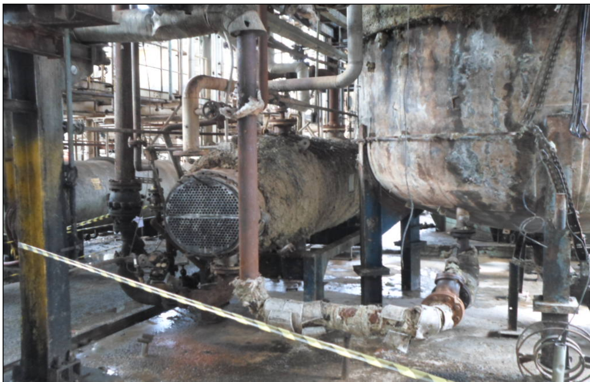
Foto 3: Trocador de calor TR-1302 e reator R-1303
