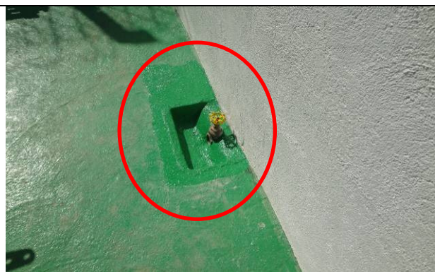
Fig. 5 - Válvula instalada no dreno
