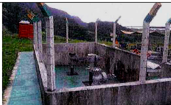
Fig. 1 - Área da Válvula V-05
