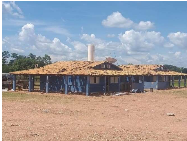
Figura 6 - Casas atingidas por detritos lançados durante o rompimento e a despressurização do duto
