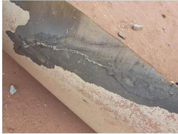
Figura 16 - Perfil da extremidade do tubo que sofreu ruptura longitudinal
