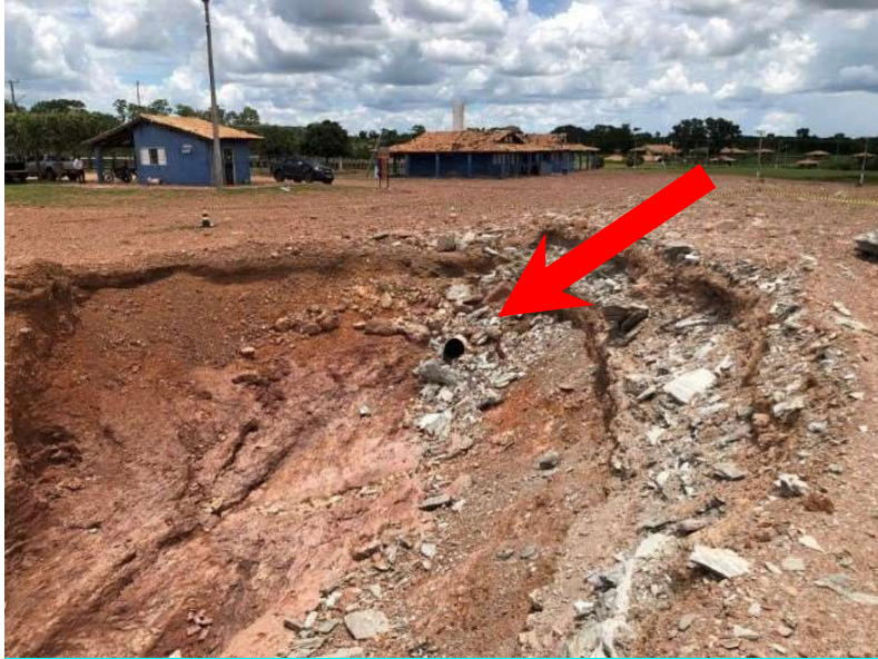
Figura 5 - Vista da cratera: tubulação exposta cercada por detritos e cascalhos
