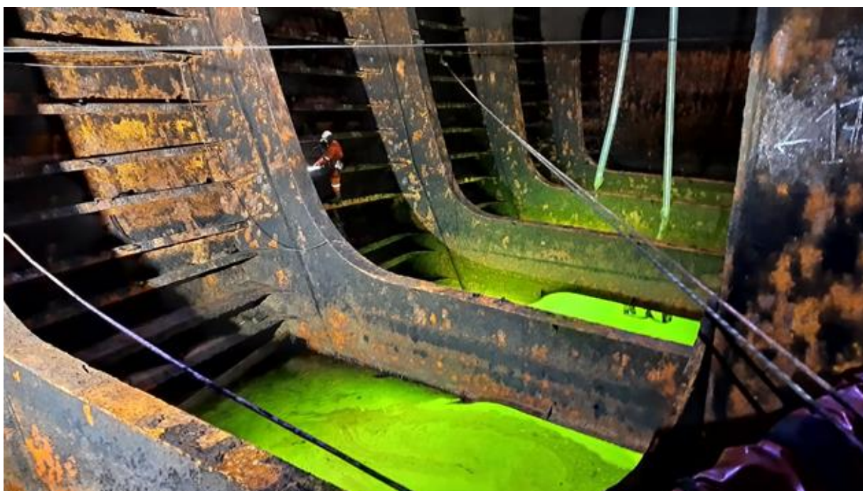
Figura 2: Fundo do casco da FPSO Cidade do Rio de Janeiro após queda da chapa.
