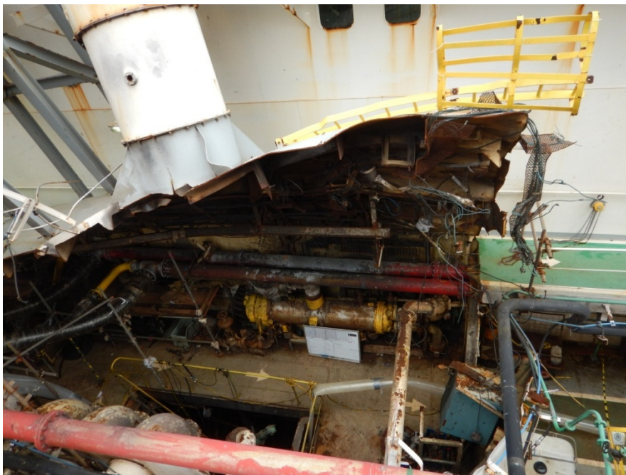
Figura 9 – Estado das linhas de incêndio da entrada da casa de bombas após a explosão
