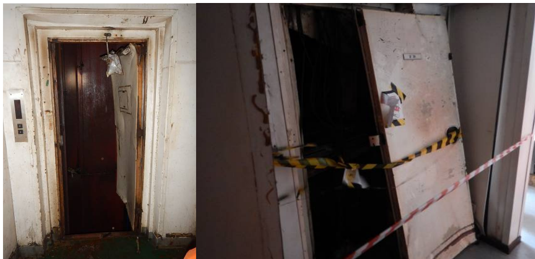
Figura 8 – Porta do elevador no nível da praça de máquinas (esq.) e no nível “D” (dir.) após a explosão
