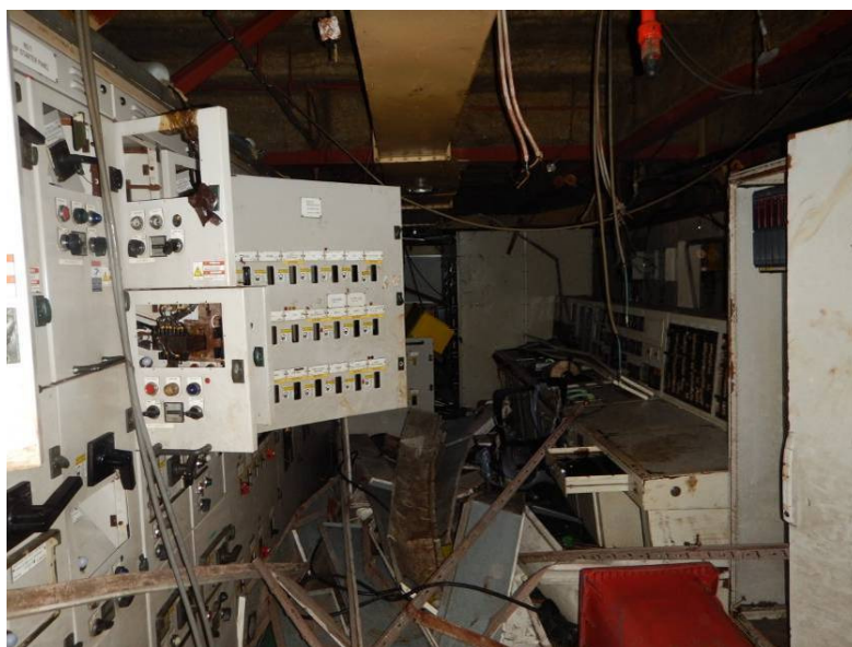
Figura 6 – Sala de controle da praça de máquinas (ECR) após a explosão
