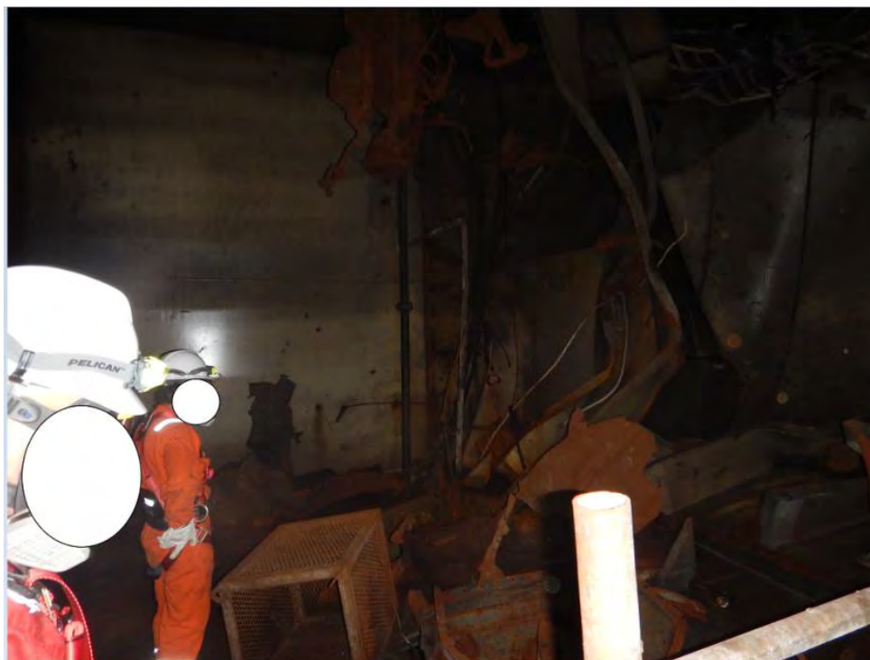
Figura 5 – Antepara rompida entre sala de bombas e casa de máquinas
