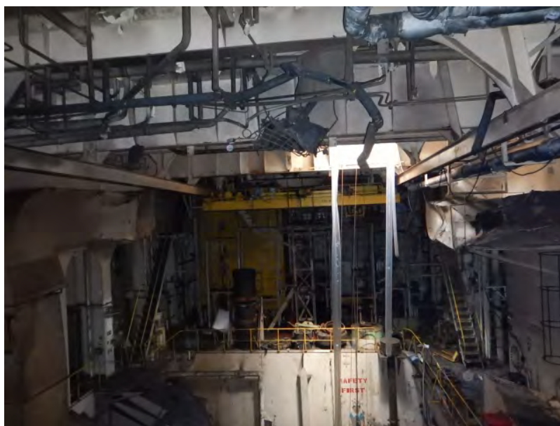
Figura 13 – Praça de máquinas após a explosão
