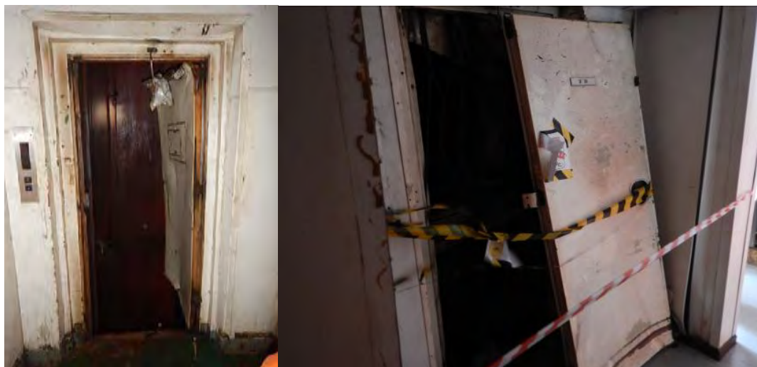
Figura 20 – Porta do elevador no nível da praça de máquinas (esq.) e no nível “D” (dir.) após a explosão
