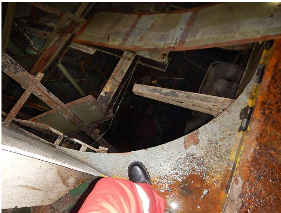
Figura 15 – Parte do piso faltando na saída de uma sala
