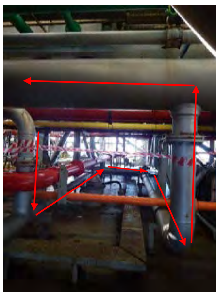
Figura 45 – Ramo da run down line para o tanque 3C
