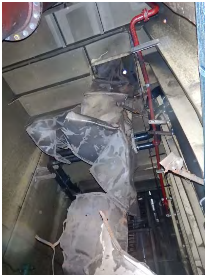
Figura 31 – Dutos de ventilação pendurados
