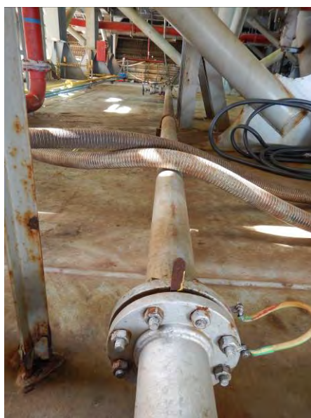
Figura 91 – Isolamento na 4C aft COW line
