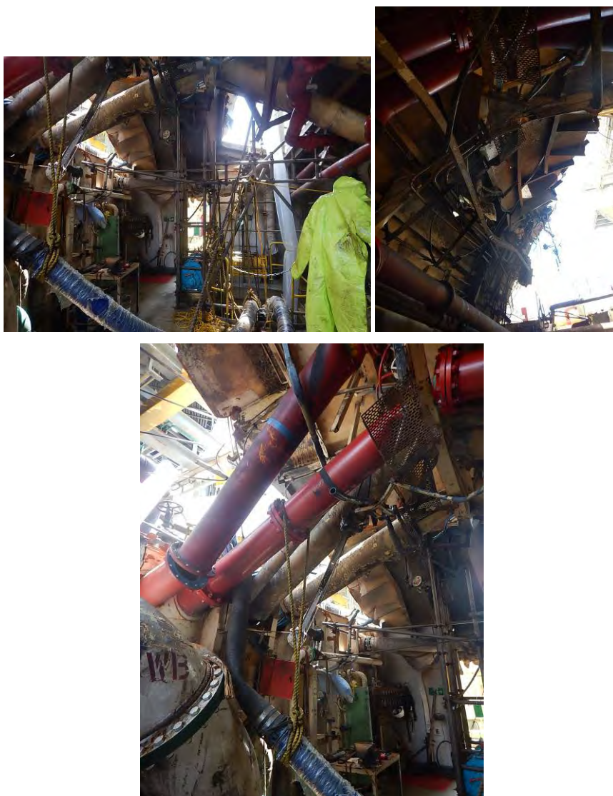
Figura 28 – Entrada da sala de bombas com teto e tubulações levantadas
