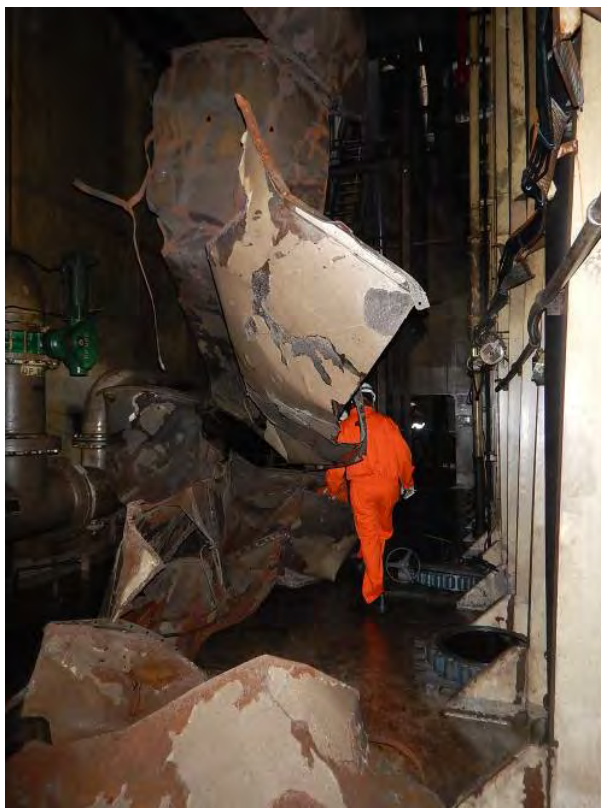
Figura 30 – Sistema de ventilação destruído e pendurado
