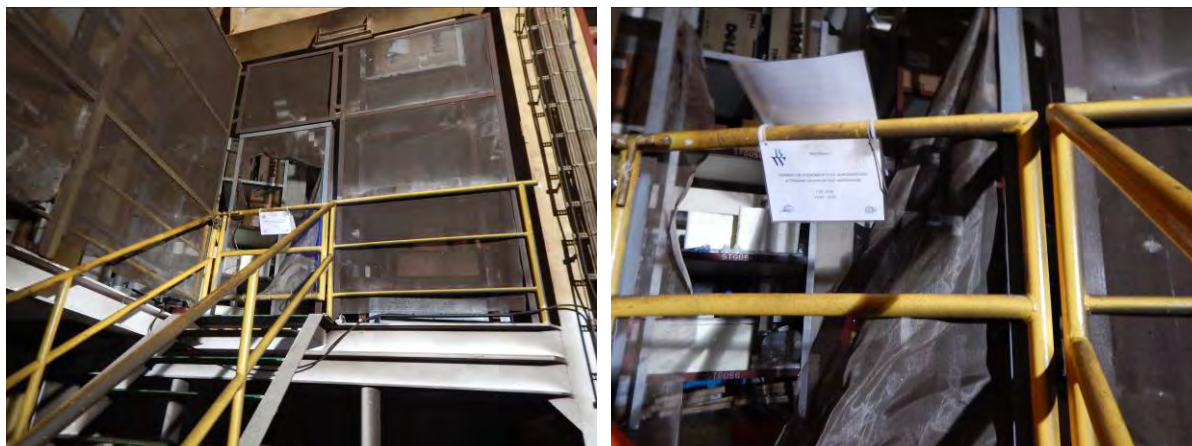
Figura 122 – Tela rompida na porta de entrada de almoxarifado
