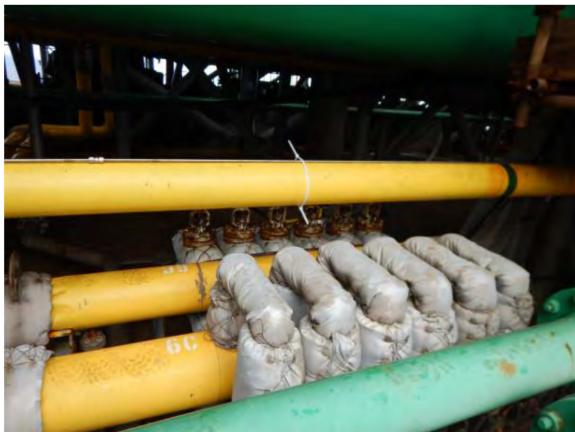
Figura 93 – Válvulas no upper deck da linha de aquecimento (vapor) do tanque 6C
