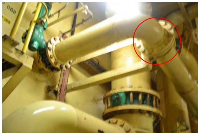
Figura 3 – Fotografia tirada antes do acidente destacando o flange por onde ocorreu o vazamento
