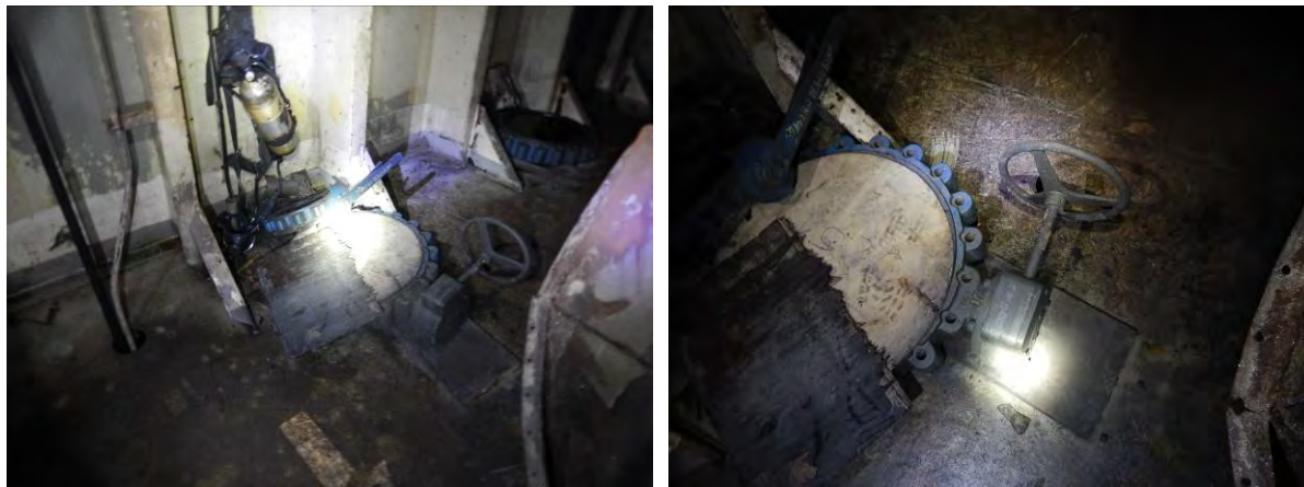
Figura 75 – Válvulas manuais não instaladas, no interior da casa de bombas
