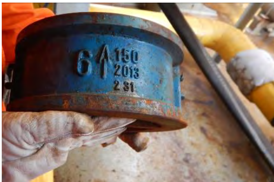
Figura 79 – Válvula de retenção ( check valve ) que estava instalada (retirada da linha após o acidente)
