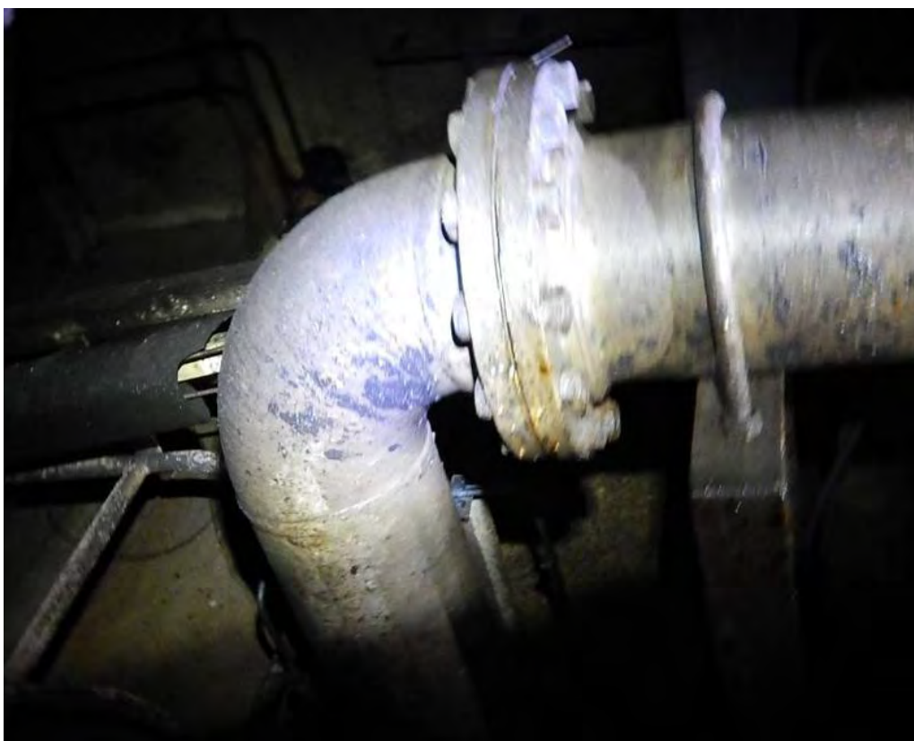
Figura 84 – Raquete instalada para isolamento da válvula OP-068
