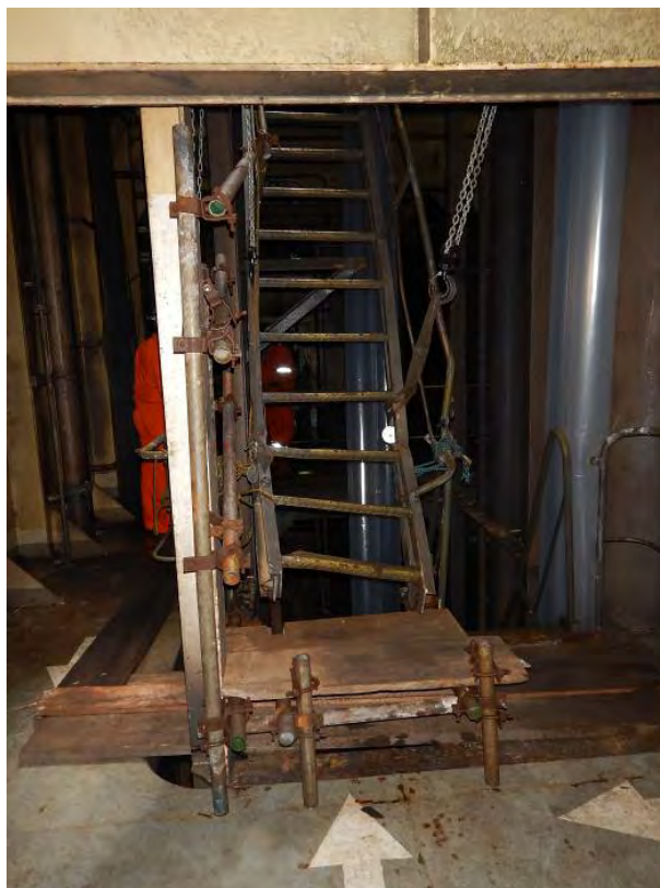
Figura 29 – Acesso danificado e provisoriamente adaptado para a passagem de pessoas
