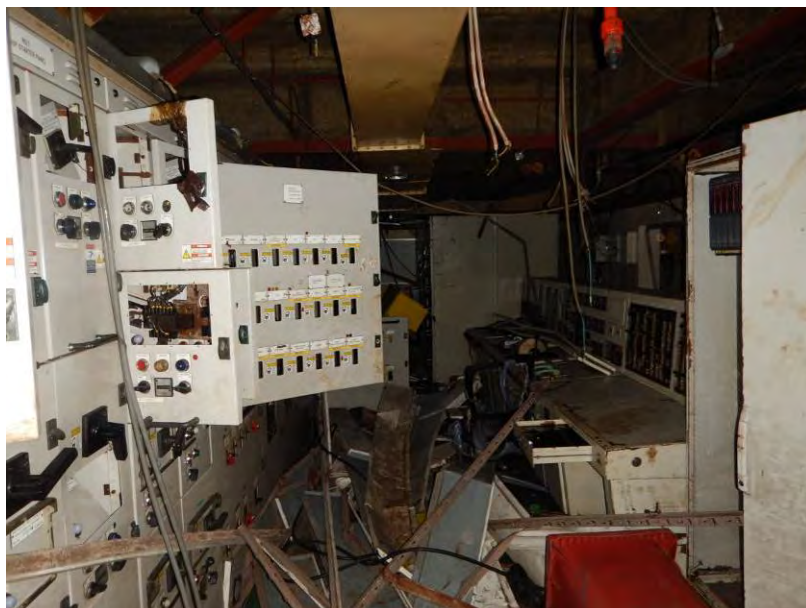
Figura 10 – Sala de controle da praça de máquinas (ECR) após a explosão
