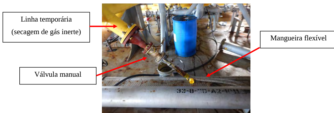
Figura 78 – Conexão das bombas submersíveis com a linha de gás inerte
