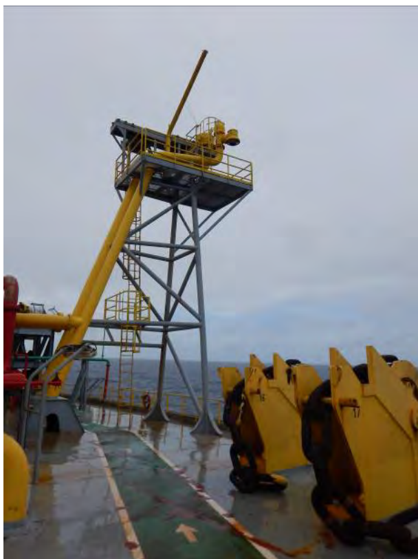
Figura 94 – Vent riser, lado boreste do navio
