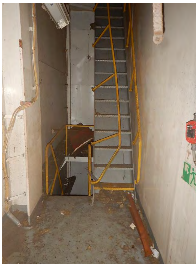
Figura 16 – Porta da área adjacente à oficina de manutenção arremessada para trás da escada
