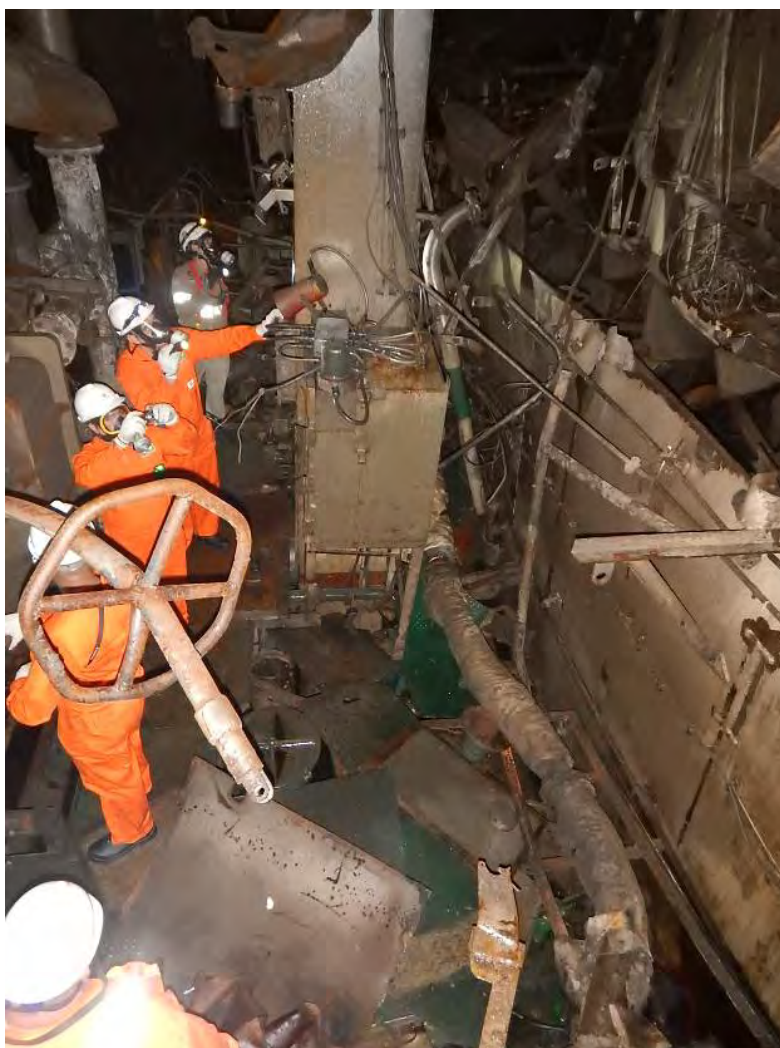
Figura 9 – Destruição ocasionada pela explosão
