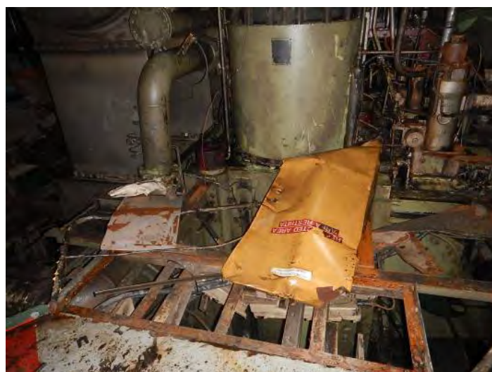
Figura 11 – Porta da outra entrada da sala de controle da praça de máquinas que se encontrava do lado de fora da sala
