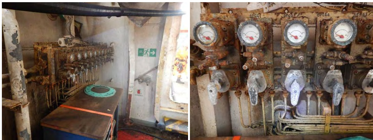
Figura 57 – Acionamento de válvulas por meio de chave no pump room top
