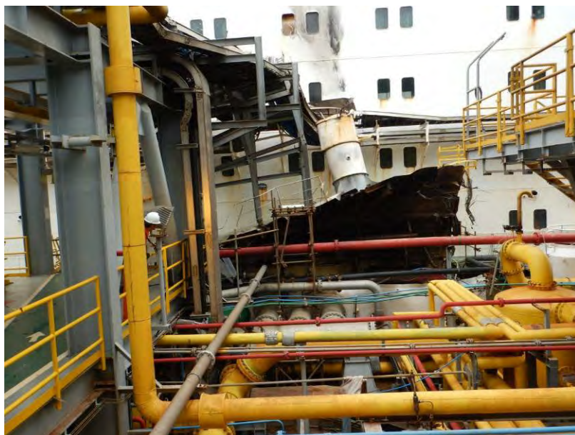
Figura 26 – Entrada da casa de bombas após a explosão.
