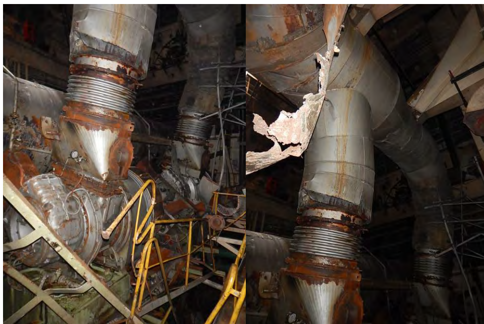
Figura 18 – Demais sistemas destruídos na sala de máquinas
