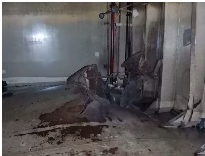
Figura 33 – Piso danificado pela explosão
