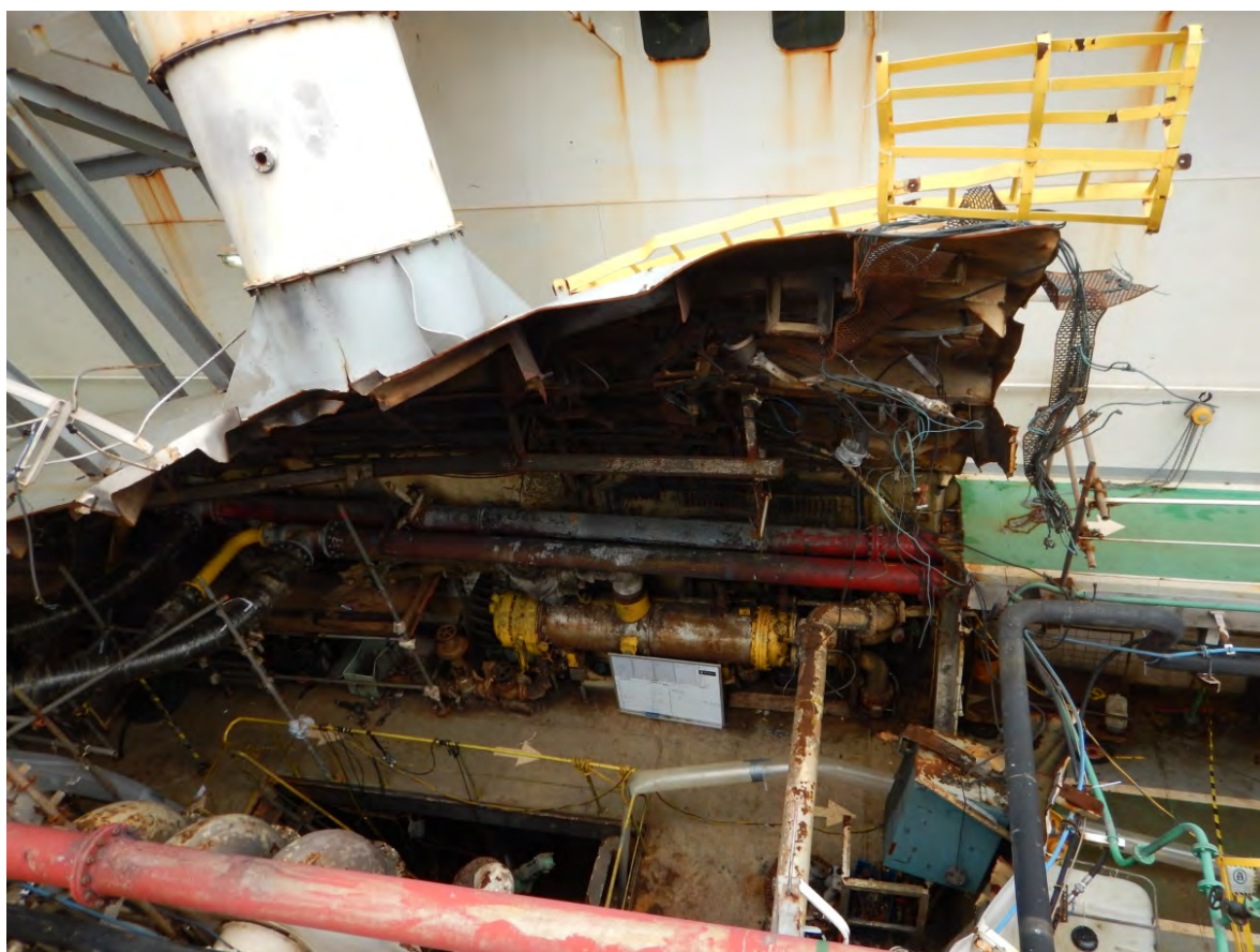
Figura 27 – Estado das linhas de incêndio da entrada da casa de bombas após a explosão
