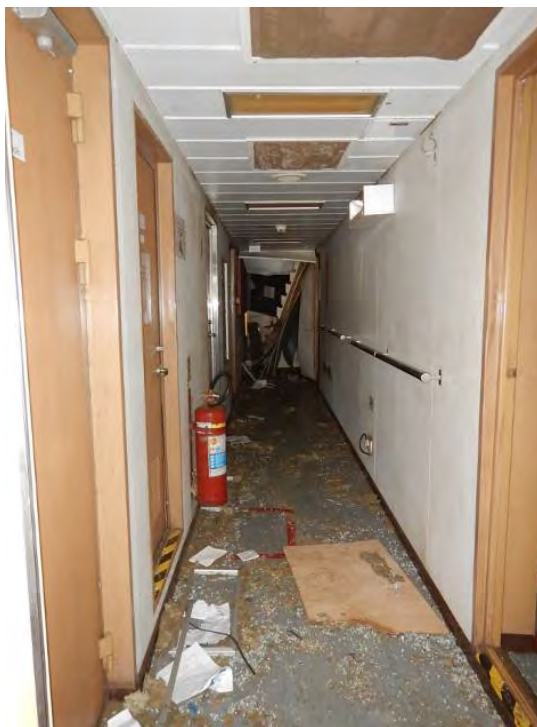
Figura 21 – Corredor do casario no nível “A” da unidade após a explosão.
