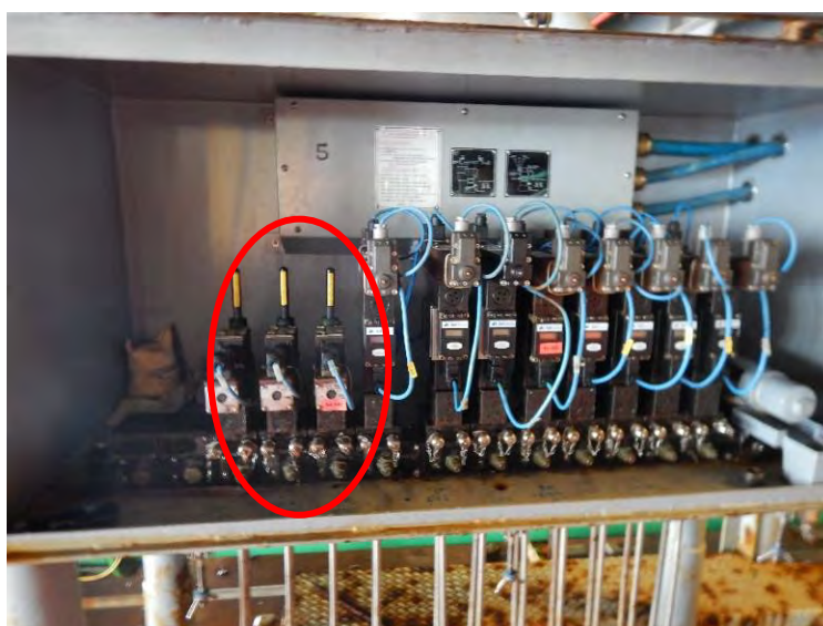
Figura 56 – Acionamento de válvula por meio de alavanca no upper deck
