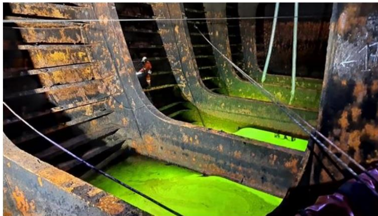
Figura 1 - Fundo do casco da FPSO após falha estrutural do tanque.
