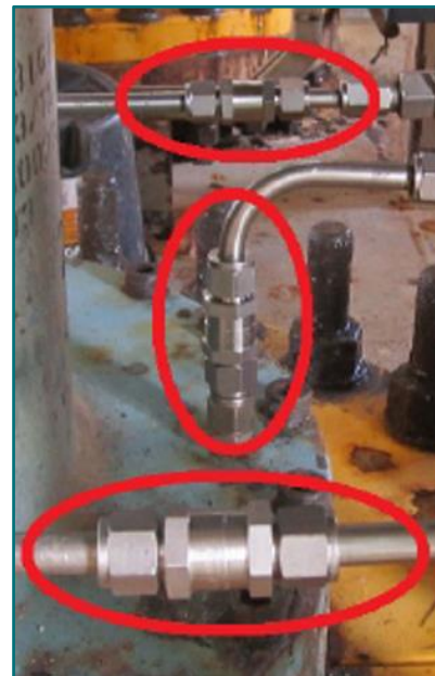
Figura 6 – GRVs instaladas nas linhas do sistema de ventilação do anular do riser após o evento
