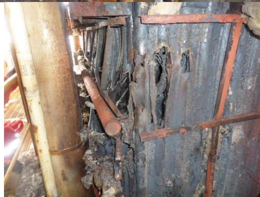
Imagens da caldeira danificada.
