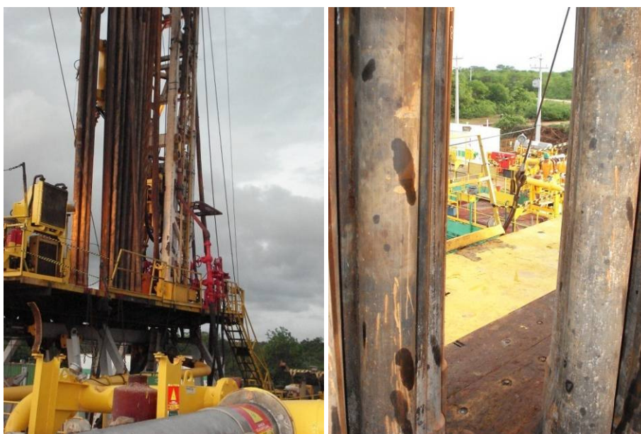
Figura 1: À esquerda, a sonda SC-115 com os tubos estaleirados de uma foto retirada da posição em que se encontrava a vítima. À direita, o detalhe do espaço entre os tubos estaleirados que permitiu a passagem do tubo que vitimou o empregado.
