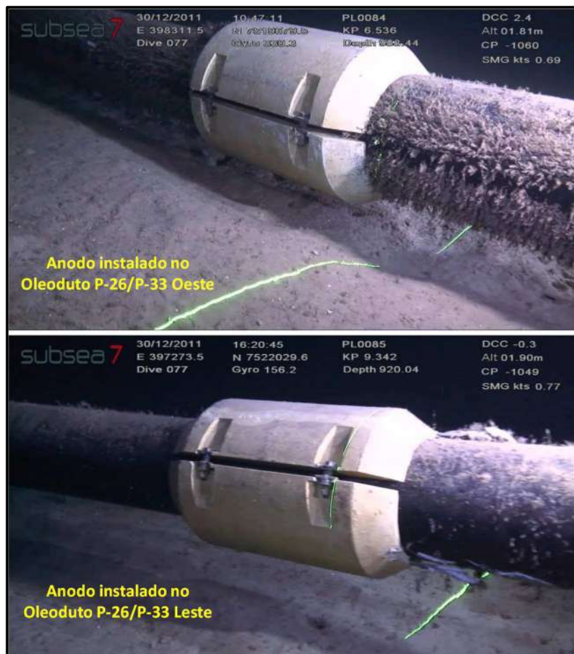
Figura 4.b-II - Fotos de Anodos instalados nos oleodutos
