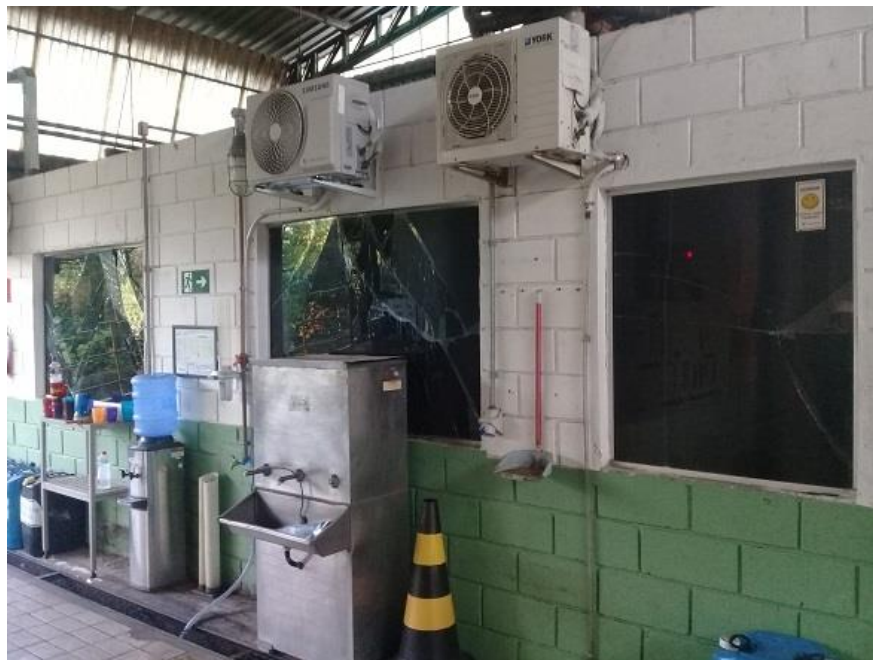
Foto 9: Janelas do laboratório e das salas do supervisor com vidros quebrados. Danos causado pelas ondas de choque oriundas da explosão.
