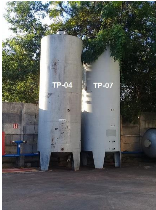
Foto 15: Decantadores TP-04 e TP-07 (que foram substituídos pelo DC-04).
