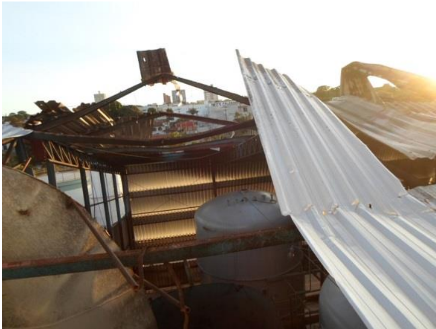
Foto 8: Chapas metálicas da cobertura do galpão e estruturas metálicas totalmente danificadas pela explosão.
