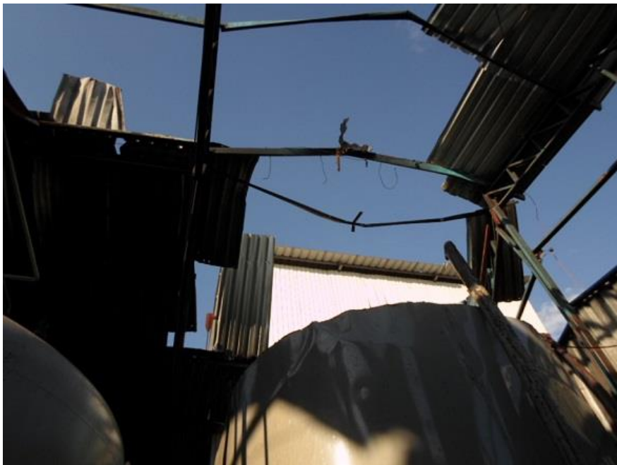
Foto 7: Topo do decantador DC-04 e cobertura e estruturas metálicas do galpão danificadas pela explosão.
