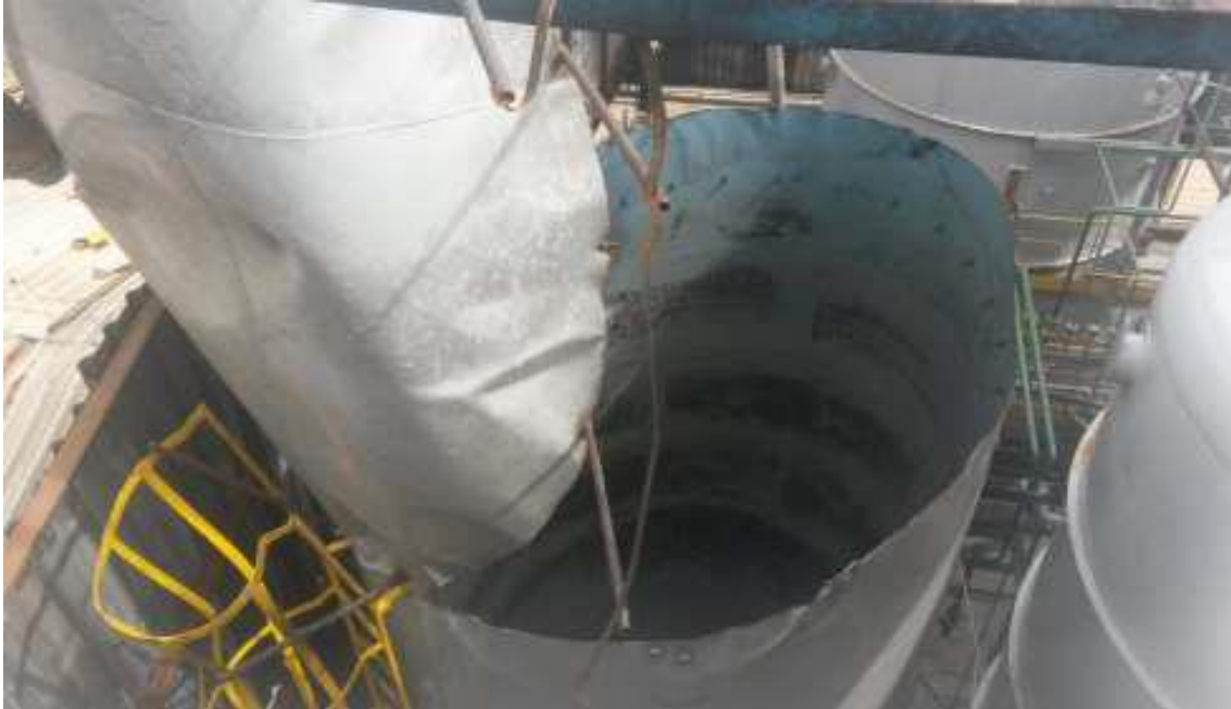
Foto 1: Vista do decantador DC-04 com o teto aberto pela explosão.
