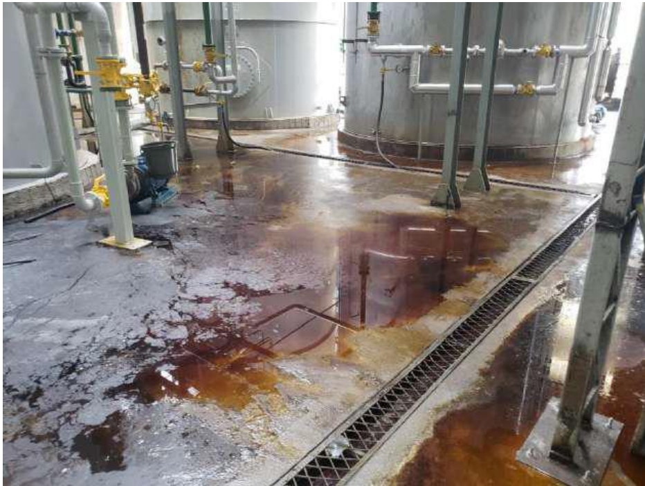
Foto 5: Substância oleosa gerada no acidente presente em canaletas e piso do galpão.
