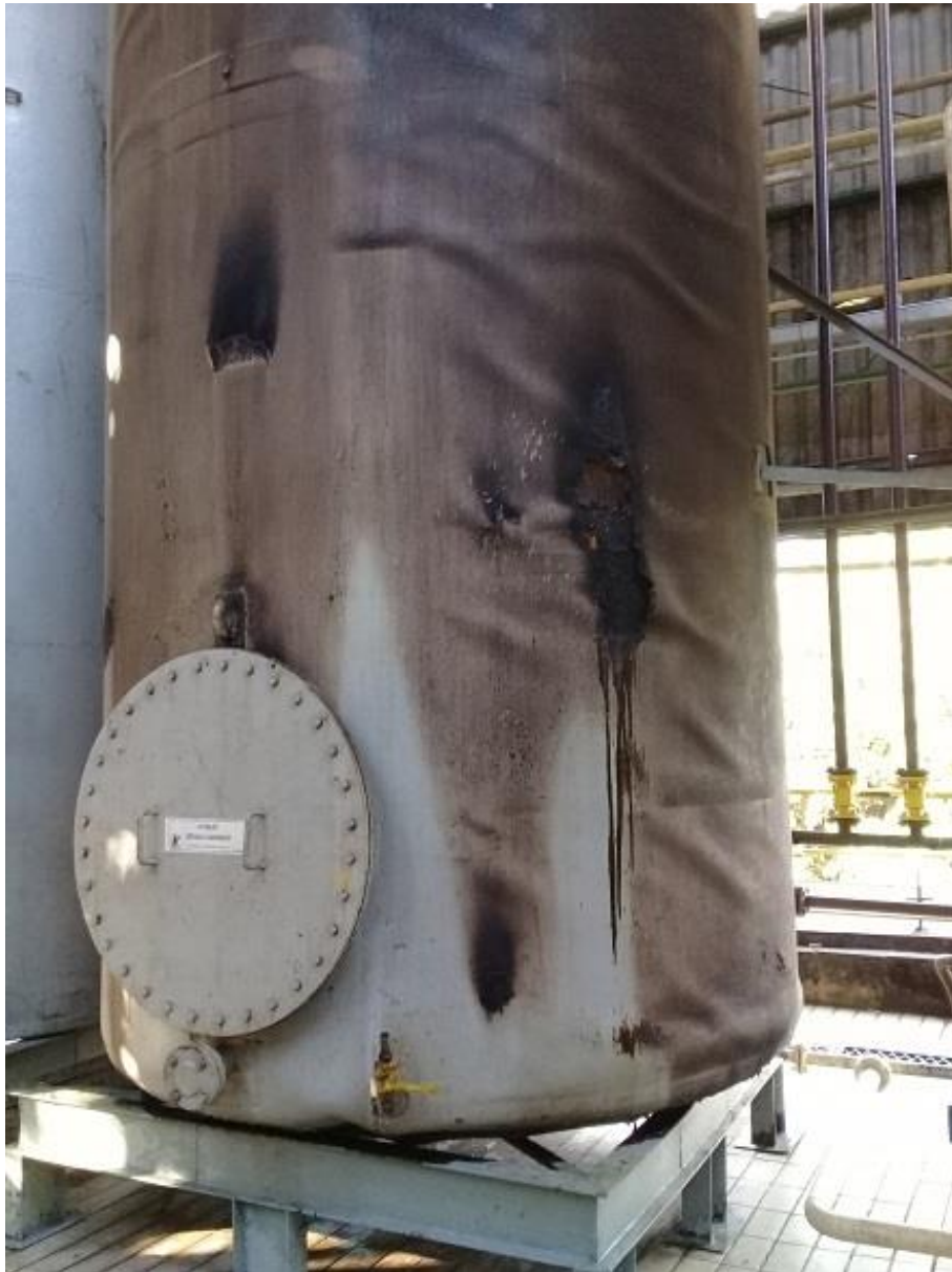
Foto 10: Decantador D-01 danificado pela chama da explosão.
