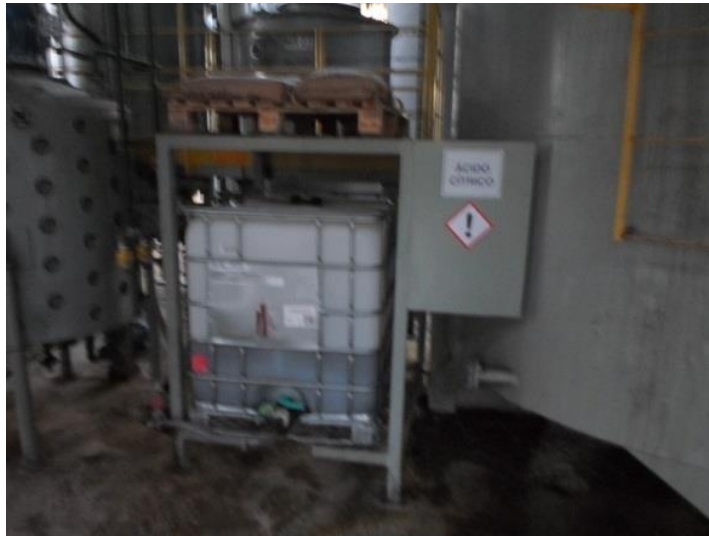
Foto 13: IBC (isotaque) de armazenamento de enzimas para o processo de hidroesterificação.
