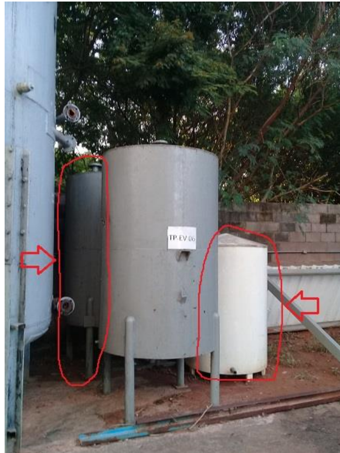
Foto 19: Retirada do tanque pulmão do evaporador TP-EV 06 e outros equipamentos não identificados (possivelmente, tanques-pulmão).
