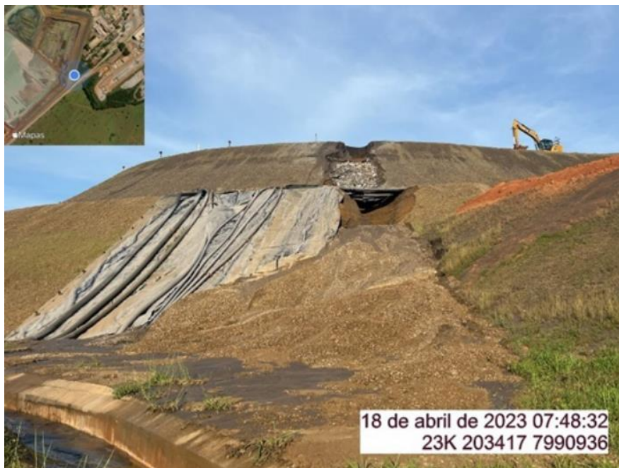
Figura 39: Vista do talude de jusante demonstrando as dimensões das erosões após o incidente.
