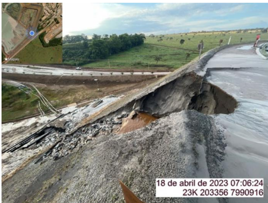
Figura 40: Vista da berma do talude de jusante e a dimensão da erosão causada pelo incidente.
