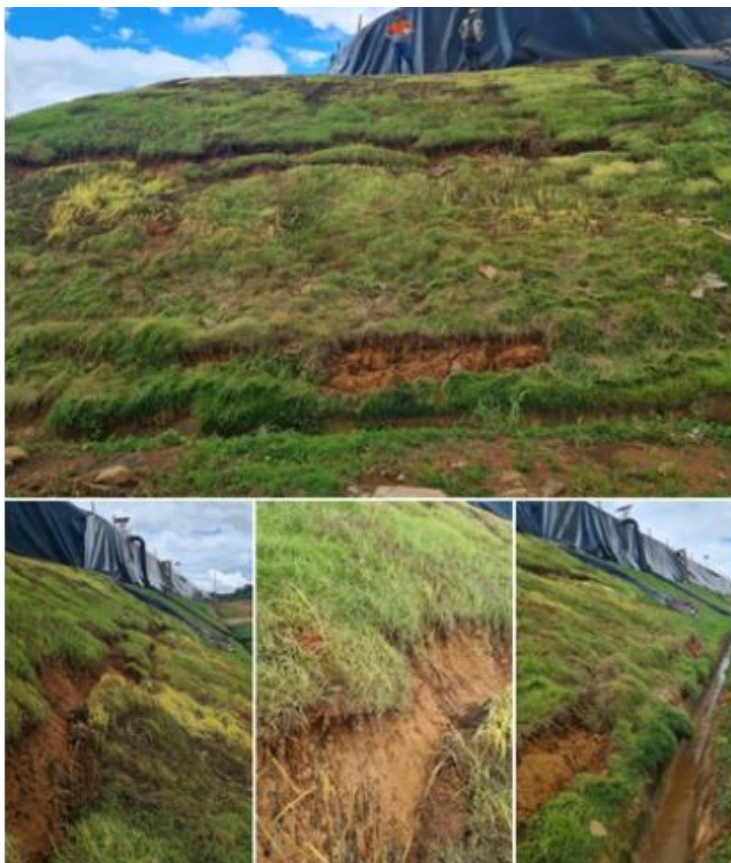
Figura 34: Imagem de um dos deslizamentos na berma da Barragem 2 – Morro Agudo.
