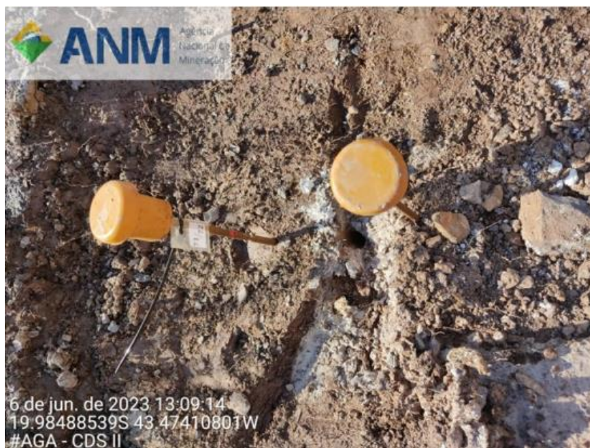
Figura 48: Pinos instalados para monitoramento manual das trincas.
