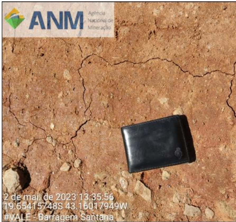
Figura 43: Trinca tipicamente observada nas bermas e acessos.
