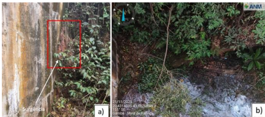
Figura 55: Contato entre a barragem e a ombreira esquerda a jusante: (a) vista geral da surgência com delimitação da região aparentemente mais afetada; (b) vista de cima evidenciando a presença de água.
