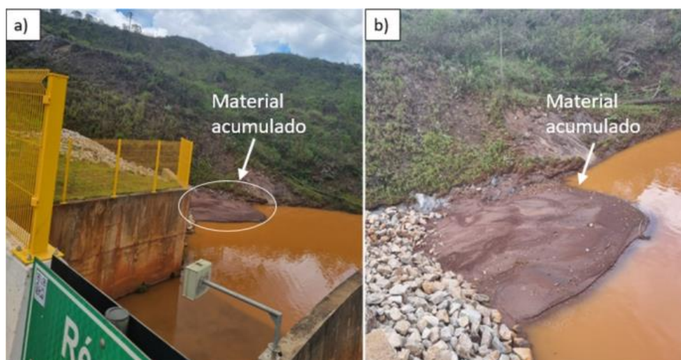
Figura 54: Emboque do extravasor da Barragem Barnabé I: (a) presença de sedimentos; (b) detalhe do acúmulo de sedimentos.
