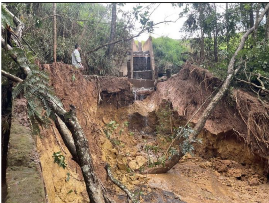
Figura 58: Rompimento da escada hidráulica do canal extravasor do sump da pilha da vila II.
