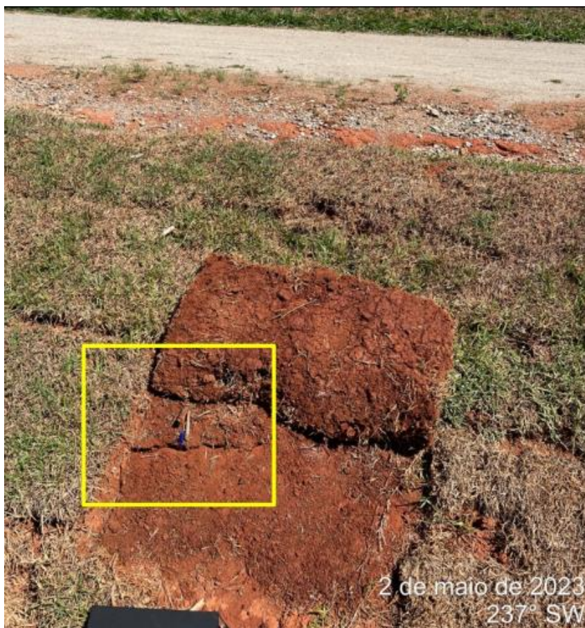
Figura 44: Destaque para a trinca em talude próximo à crista.
