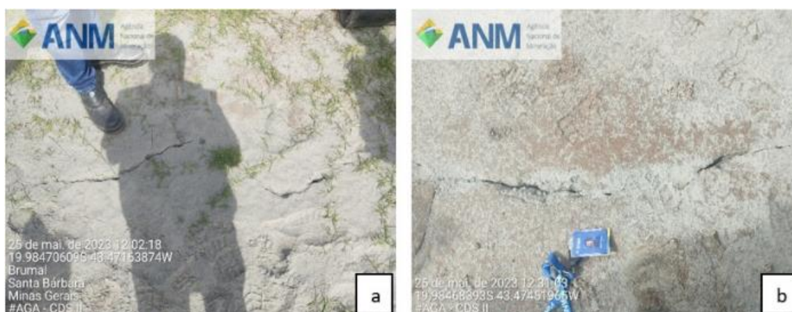
Figura 45: Caracterização da trinca longitudinal localizada no reservatório, próximo à crista evidenciando (a) característica geral da trinca e (b) escala.
