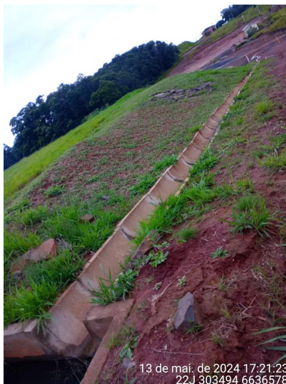
Figura 7: Sistema de drenagem superficial da Barragem Bacia de Finos da Mina do Cerro (Fonte: Copelmi Mineração Ltda.).
