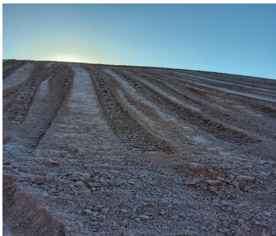
Figura 3 - Vista do talude da pilha após início da conformação. Fonte: Agência Nacional de Mineração.
