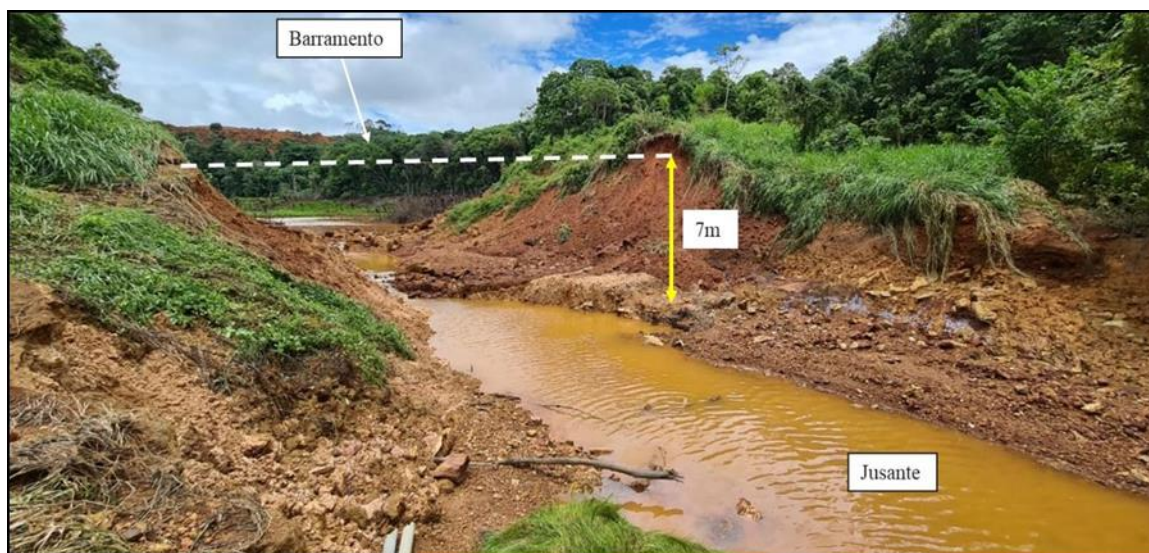
Figura 11: Situação do barramento após o galgamento.
