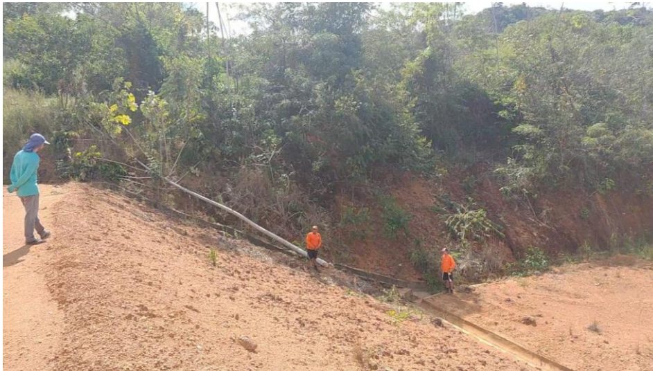
Figura 5: Corte de árvores que nasceram no talude da barragem.
