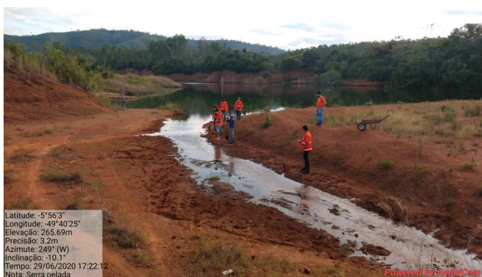
Figura 3: Extravaseiro de emergência assoreado.
