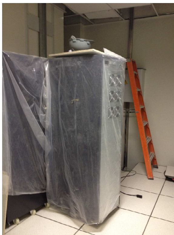
Figuras 13 e 14: Nova Sala-Cofre – Vista Interna
