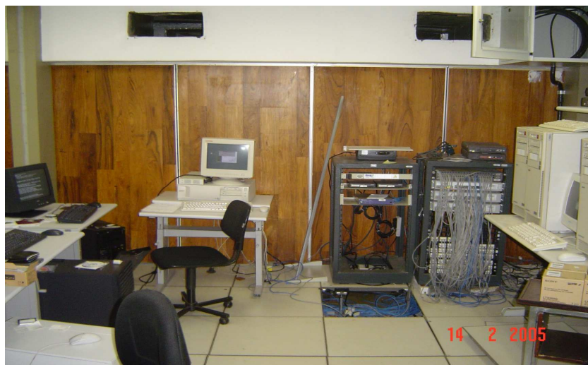
Figura 7: Visão do ambiente de CPD – Ano 2005 - Cabeamento
