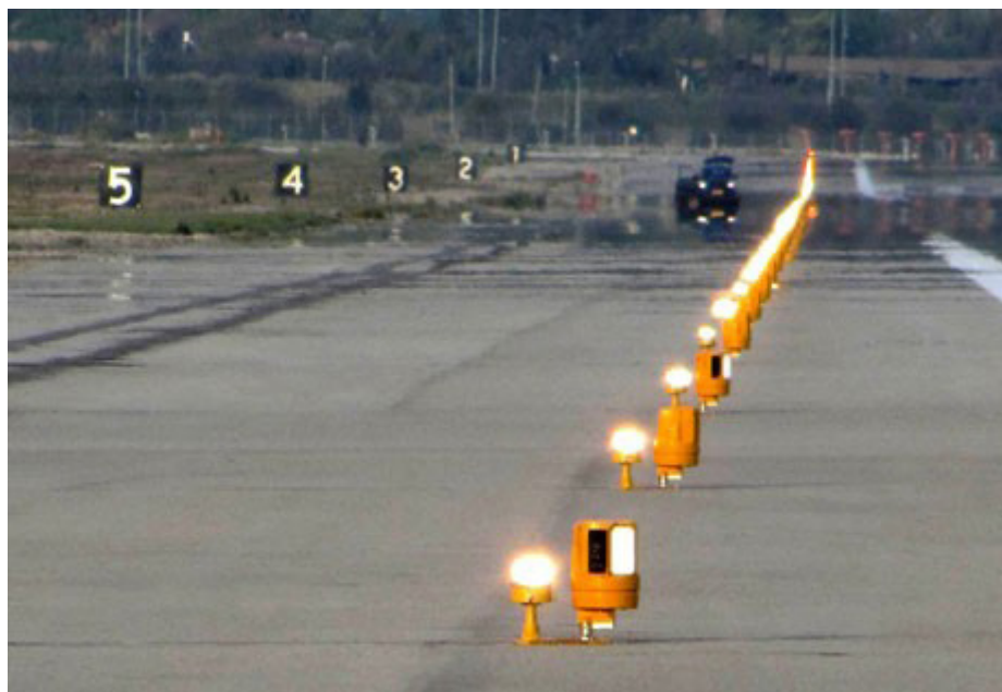
Figura 33 Instalação do detector da Xsight junto ao balizamento de uma pista (XSight, 2018).
