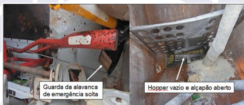
Figura 5 - Guarda da alavanca de emergência solta, e hopper vazio, com destaque para o alçapão aberto.
