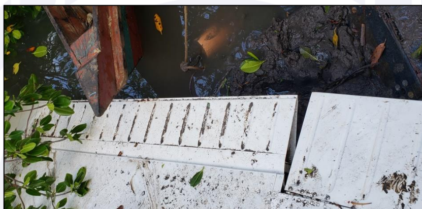
Figura 20 - Asa esquerda no local do acidente.
