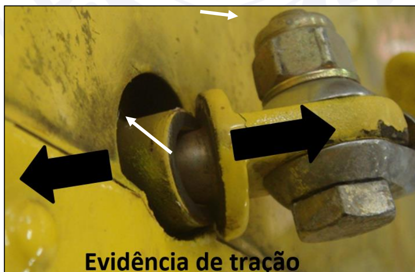
Figura 7 - Fixação do montante com característica de sobrecarga e deformação por tração (detalhe da Figura 6).
