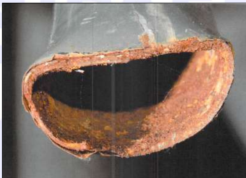
Figura 29 – Tubo da treliça fraturado por sobrecarga, com deformações do tipo “boca de peixe” nas rupturas dos tubos.
