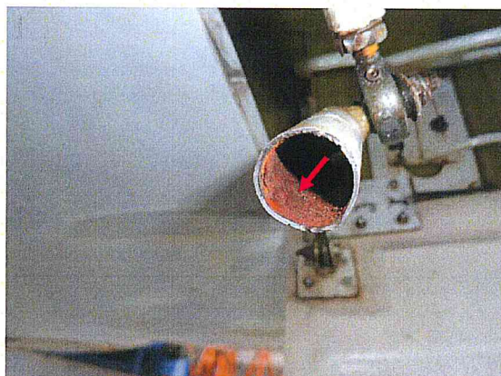
Foto 03 – corrosão na parte interna da haste (tubo) fraturada
