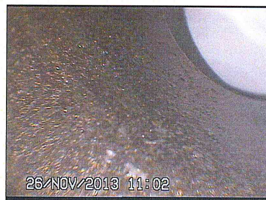
Foto 6 – câmara interna da FCU apresentando contaminação
