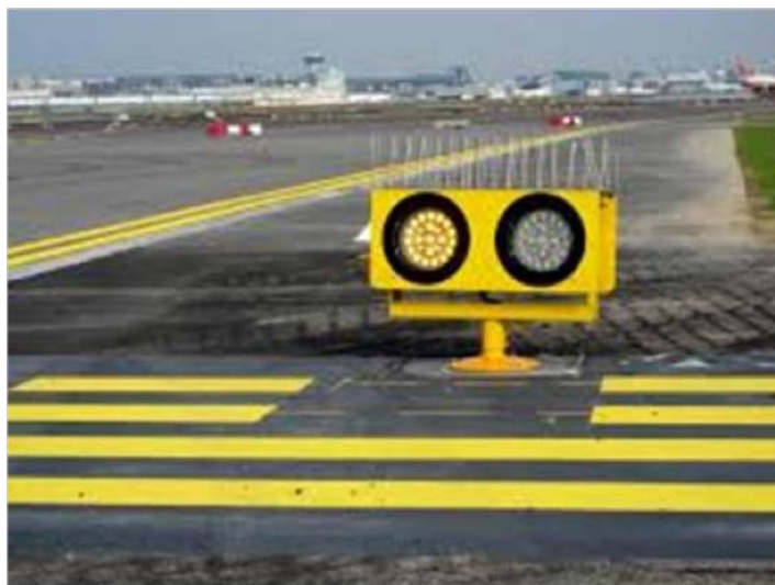
Figura A.16 Luzes de proteção de pista de pouso e decolagem
