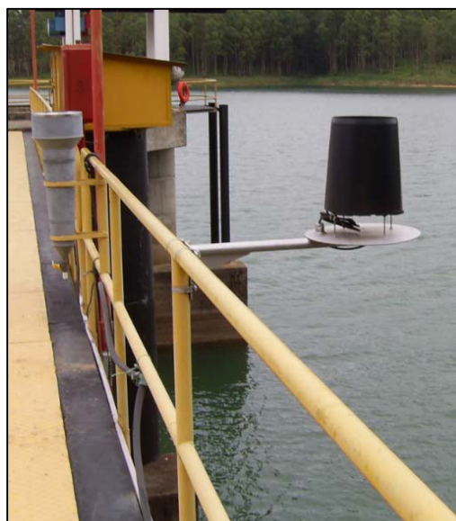
Figura 26 – Estação telemétrica Barragem Atibainha
