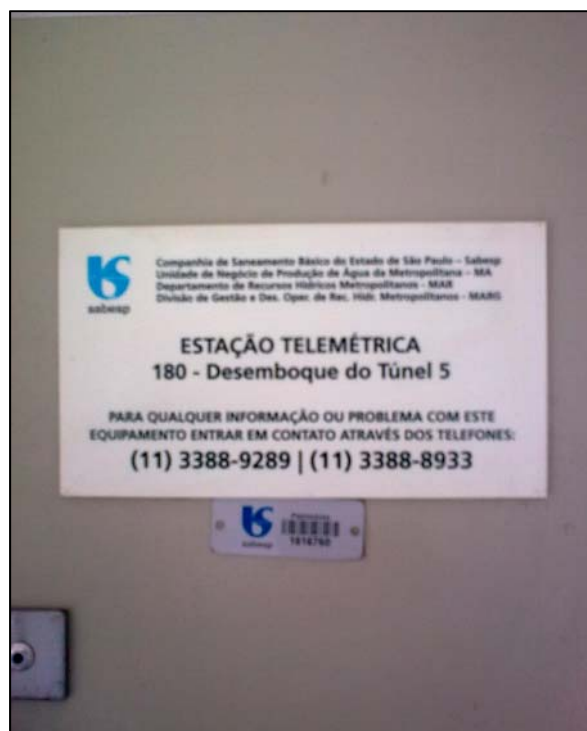
Figura 38 – Caixa com identificação e estação telemétrica
