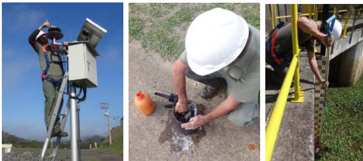
Figura 10 – Atividades da manutenção preventiva nas estações telemétricas.
