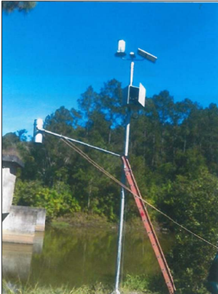
Figura 36 – Estação telemétrica instalada no Desemboque do Túnel 6
