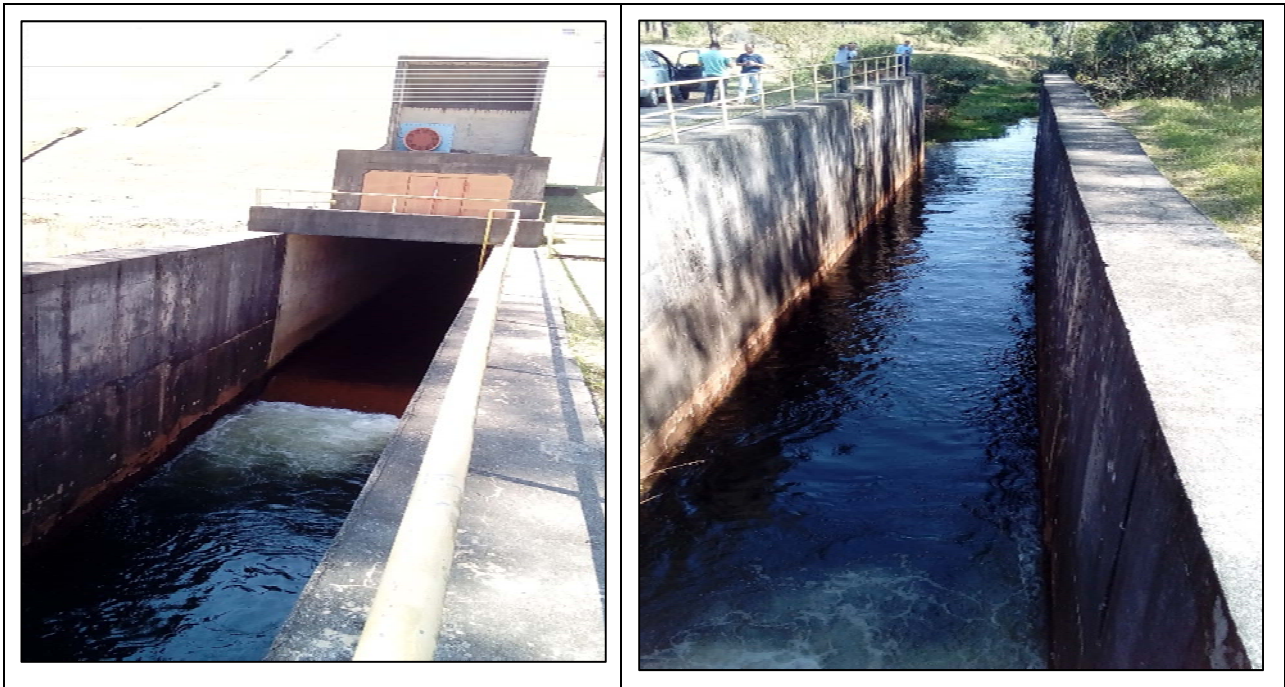
Figura 14 - Descarregador de fundo da Barragem Jacareí
