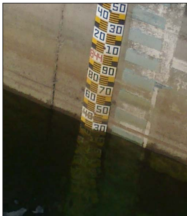
Figura 17 – Régua linimétrica Barragem Jaguari
