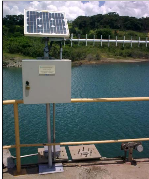
Figura 18 – Estação telemétrica instalada na Barragem Jacareí
