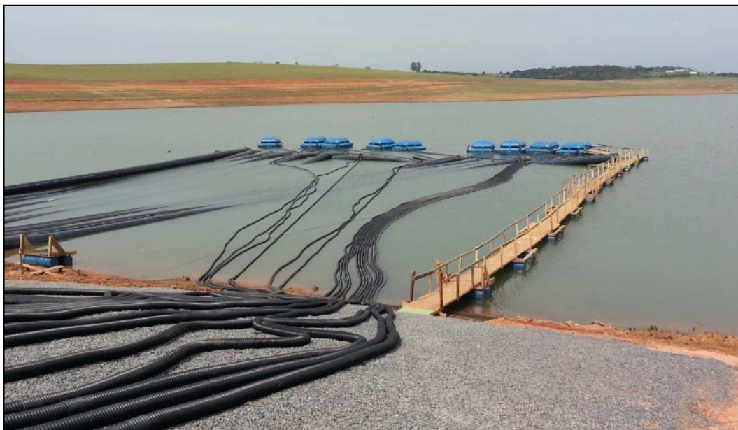
Figura 8 – Captação da reserva técnica na Represa Jacareí (Jacareí II)
