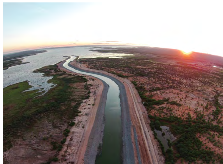
Canal de aproximação - Eixo Leste Execução das obras do canal de aproximação do Eixo Leste conduzidas pelo MIDR
