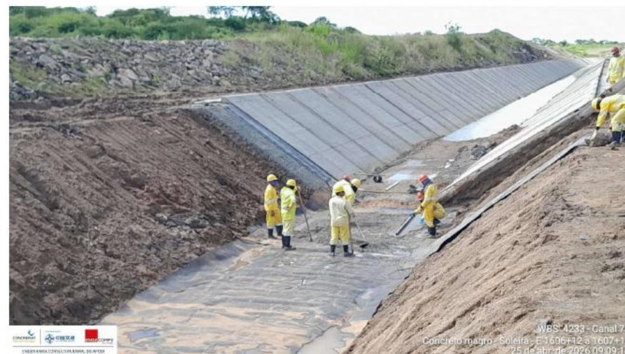
Foto 2: regularização da soleira
