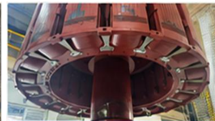
Instalação de aletas defletoras de ar interpolares
