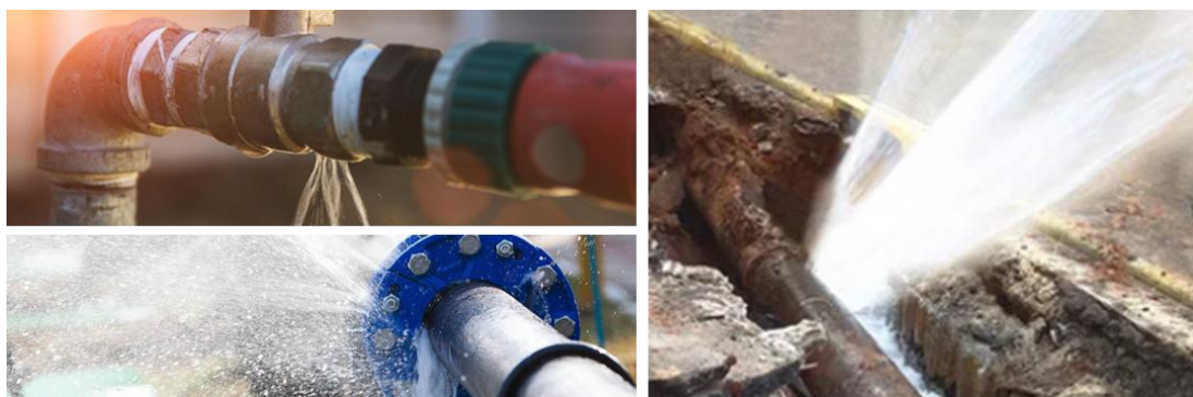
Figura 8 - Evidências de vazamentos visíveis: Imagens do Instituto Trata Brasil
