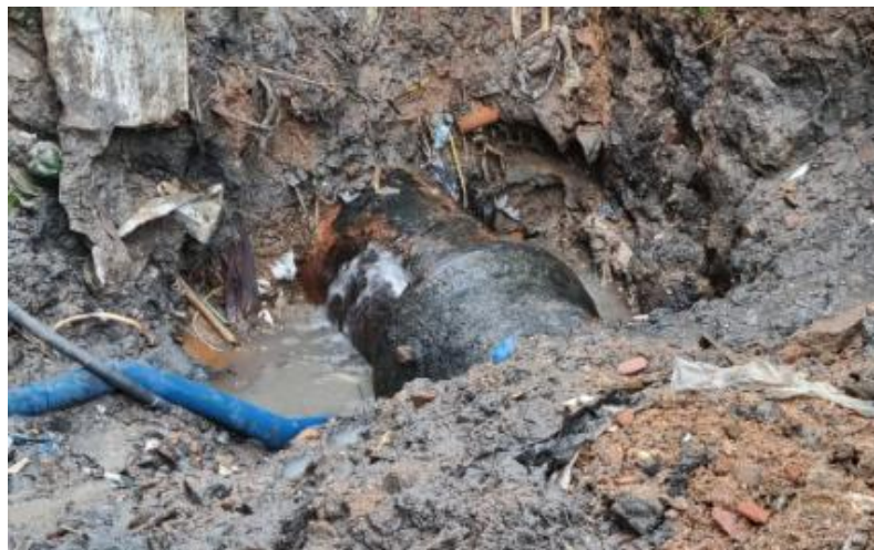
Figura 11 - Vazamento no município de São Gonçalo
