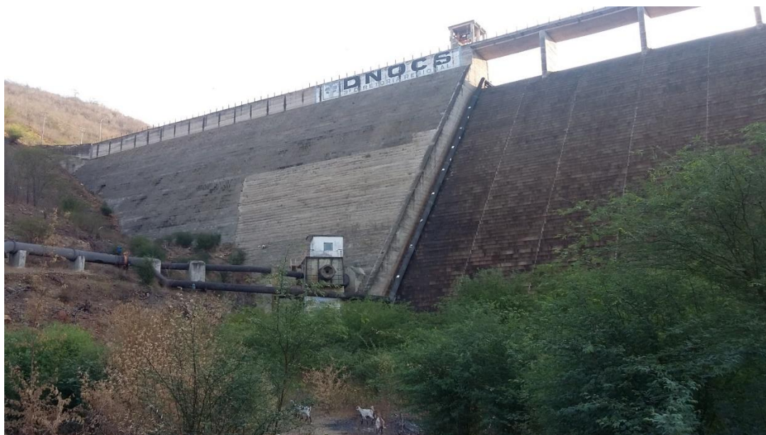
Figura 6 – Dupla adução para descarga – sifão e descarga de fundo – vista jusante
