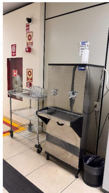
Foto 38: 1º Pavimento – Bebedouro Circulação
