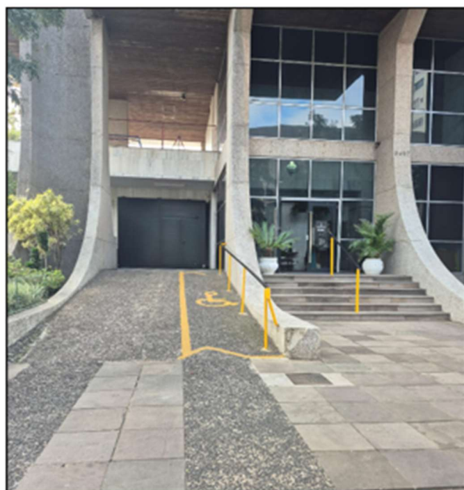
Figura 3 - Desnível na rota acessível.
