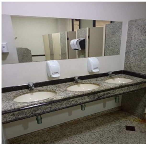
Foto 23 – lavatórios no sanitário coletivo.
