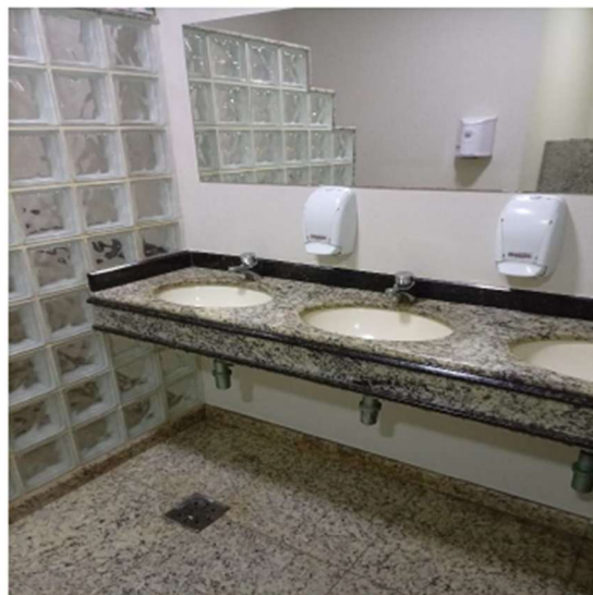
Foto 22 – lavatórios no sanitário coletivo.
