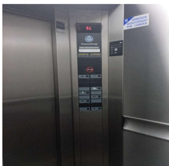
Foto 18 – cabine do elevador.
