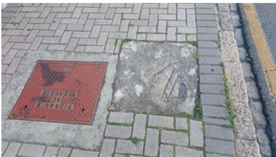
Foto 2 - Tampa em concreto na calçada.
