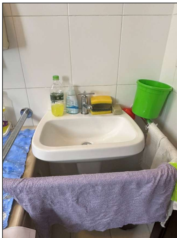
Figura 43 - Sanitário adaptado - lavatório.
