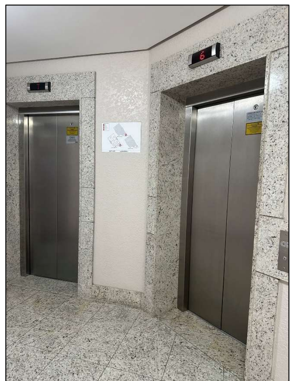
Figura 30 - Vista das portas externas dos elevadores, no 6º andar.
