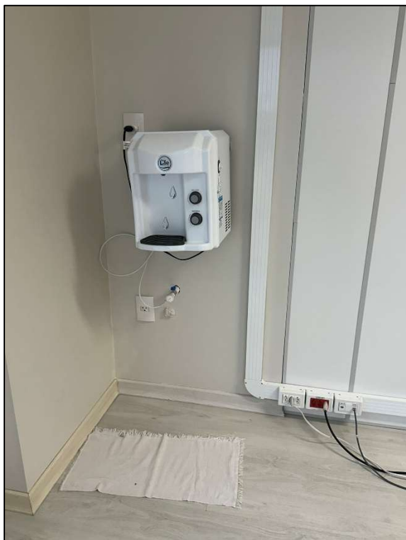
Figura 50 - Purificador de água em sala do 6º andar.
