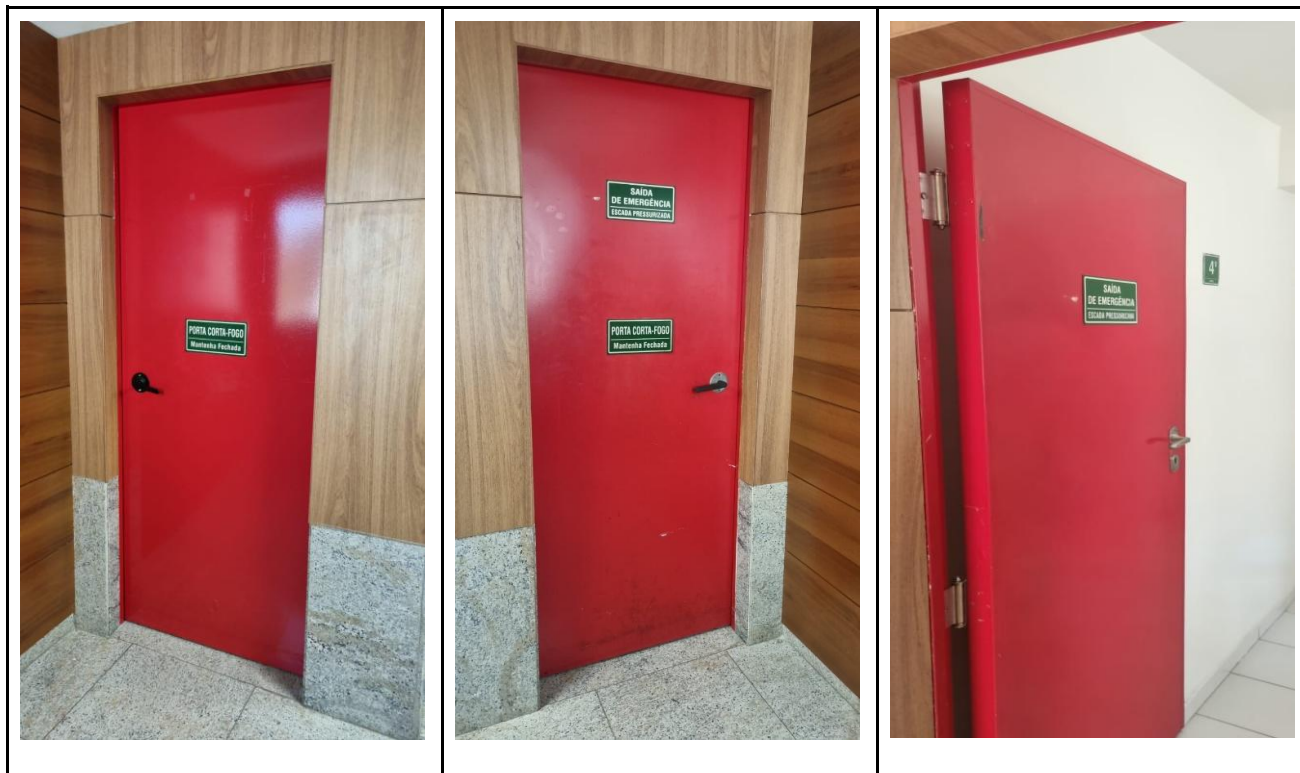
FOTO 9: Nas escadas interligando vários pavimentos não há, junto às portas corta-fogo, sinalização tátil, visual e/ou sonora, informando o número do pavimento. Não há padronização.
