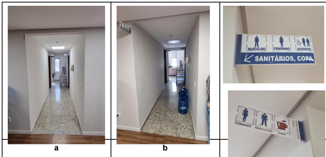
FOTO 19: Foto 19.a. 8º andar - Identificação ao acesso aos banheiros sem sinalização. Banheiro PCD transformado em copa; Foto 19.b. Apesar da sinalização, não existe banheiro destinado à Pessoas com Deficiência. Foto 19.c. Identificação ao acesso aos banheiros com sinalização, porém instalada em altura inadequada, a aproximadamente 2,04m do piso acabado nos corredores. Não há sinalização com piso tátil e Braille no batente ou na lateral da porta, além de apresentar ausência de padronização visual conforme critérios normativos de acessibilidade e sem o símbolo internacional de Acesso (SIA) nos pavimentos. Os: os demais andares precisam de padronização e adequação.
