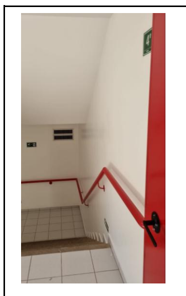
FOTO 10: Não há piso tátil, não há sinalização em Braille. Não há sinalização de acesso às áreas de resgate.
