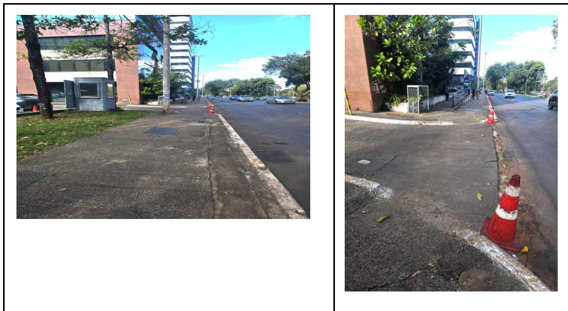
FOTO 1: Percurso sem sinalização de piso tátil direcional (do portão principal ao ponto de ônibus). Necessidade de adequação de piso tátil e reparo de depressões.
