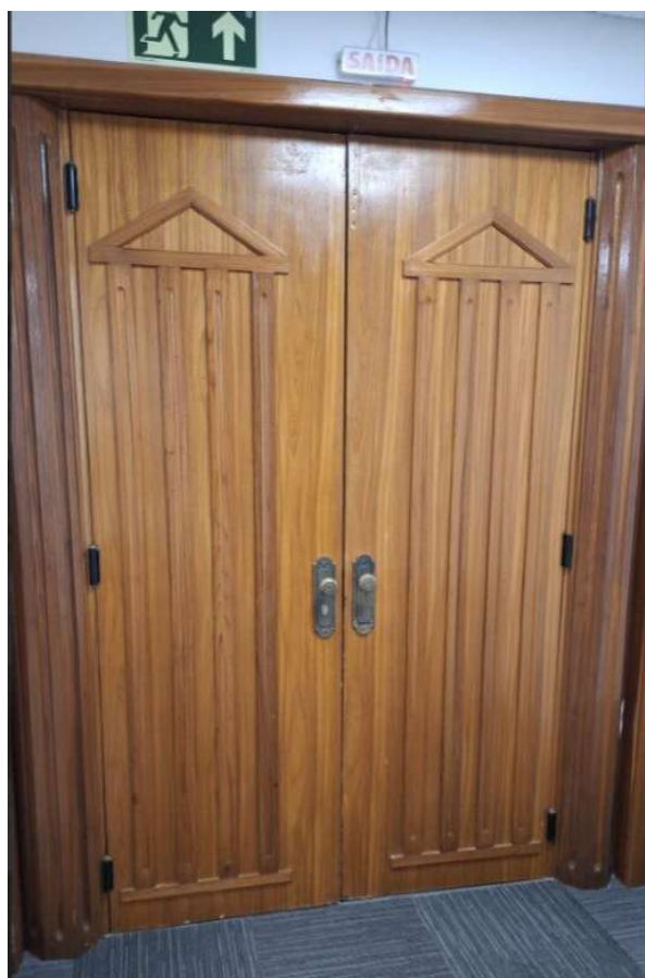
Foto 39 – cobertura. Porta do auditório.
