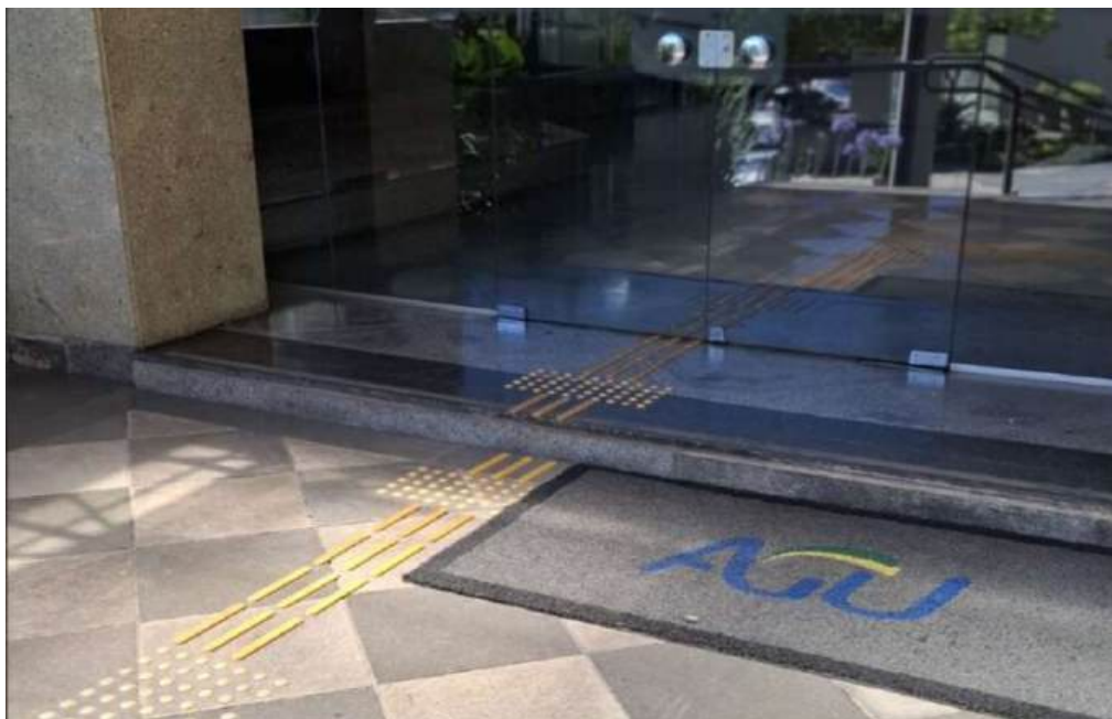
Foto 29 – térreo. Degrau isolado junto ao acesso principal.
