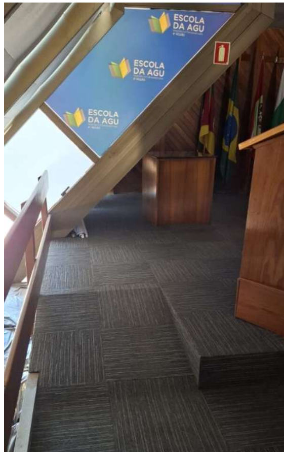
Foto 65 – cobertura. Rampa para palco do auditório.
