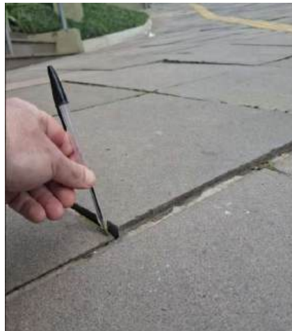
Foto 3 – térreo. Desnível calçada externa.
