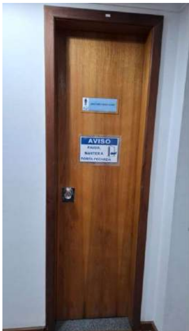
Foto 34 – andares. Portas de sanitários
