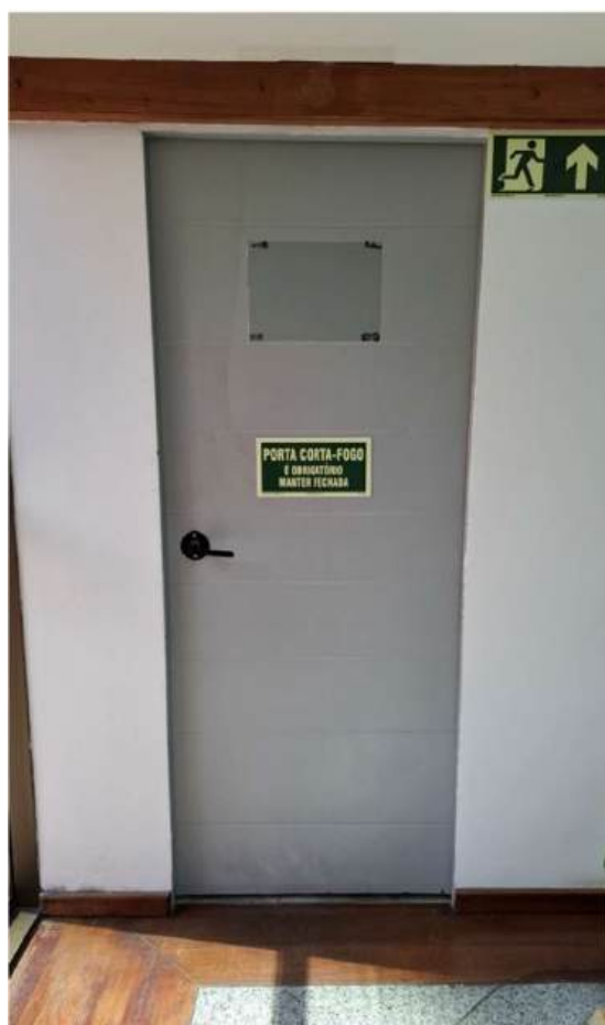
Foto 73 – pavimentos tipo. Padrão de sinalização - saídas de emergência.
