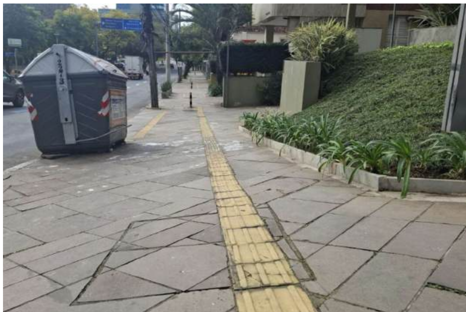
Foto 4 – térreo. Inclinação calçada externa.
