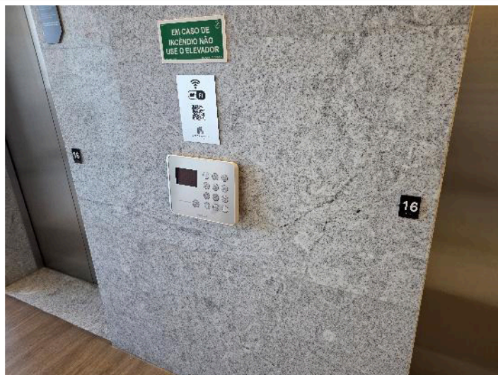
Fotografia 15 - Botoeira e placas de identificação dos elevadores nos andares.
