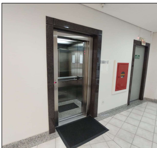
Figura 12 - Porta do elevador no 2º andar.
