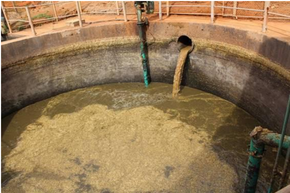
Tanque receptor e homogeneizador dos dejetos
