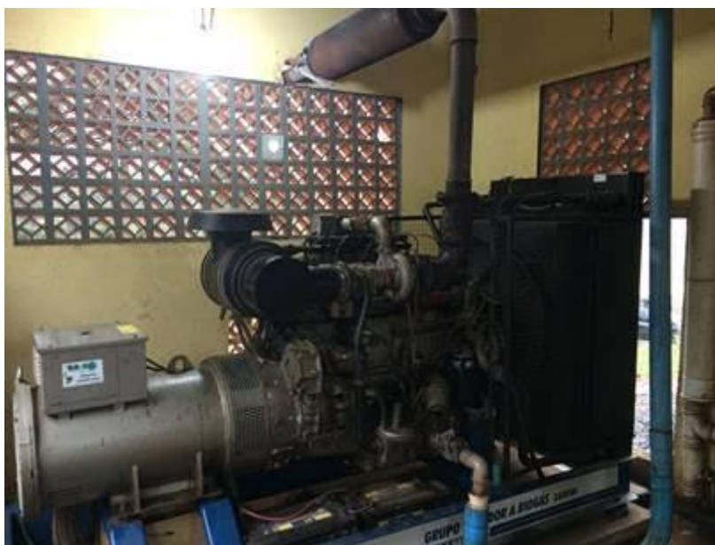
Gerador movido a biogás da Granja São Roque.
