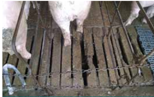
Figura 10. Piso ripado quebrado, sujeitando a matriz a lesões e desconforto.
