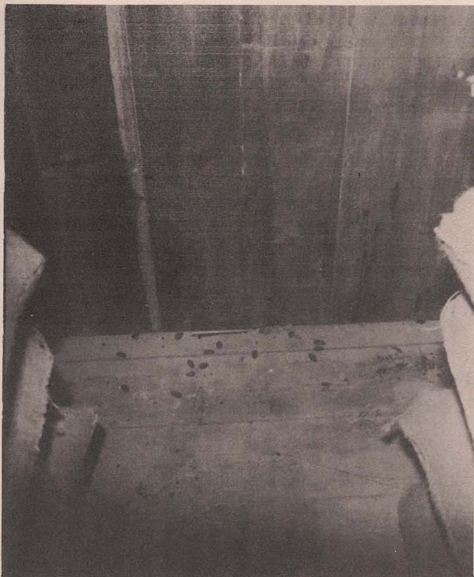
Figura 2 — Fendas entre as tábuas de revestimento de paredes e piso de um armazém de cacau, propícios à acumulação de lixo e ao alojamento de insetos.
