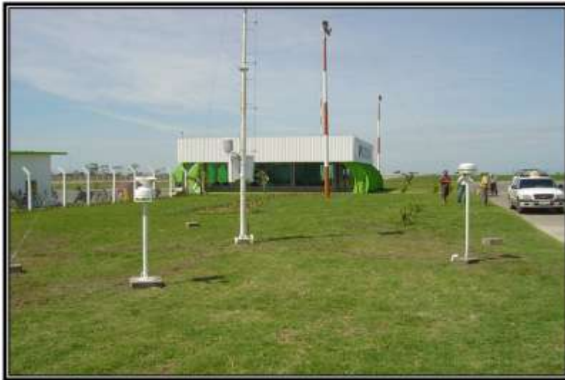
Figura 49: Estação Automática de Superfície instalada e em operação ESMET Vitória/ES – Aeroporto
